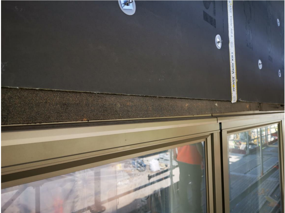
Kuva 13. Lämmöneristyksen osakohteen tarkastuksessa havaittuja puutteita
