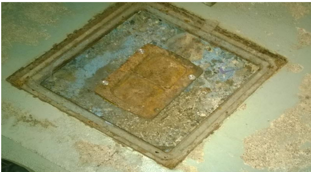
Kuva 5. Kellarin lattiassa tarkastusluukun alla on pohjaviemäriin puhdistusluukku. Pohjaviemäriin korko on lähellä lattiaa.
