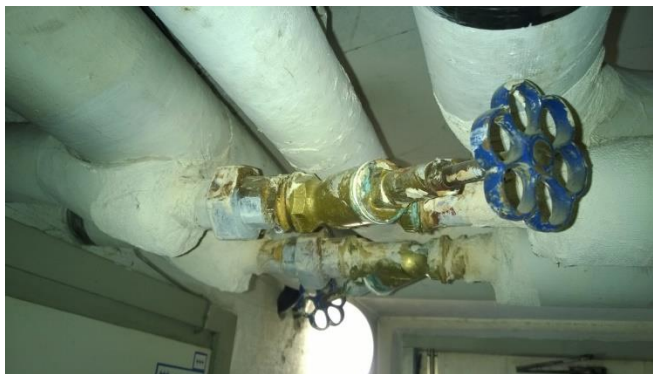
Kuva a. Vinokartioventtiili kellarin käytävällä.
