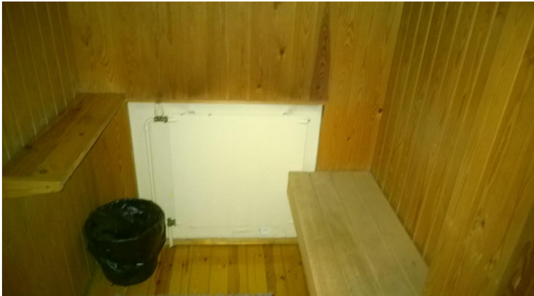
Kuva 4. Saunaosastolla radiaattori on seinäpaneelien sisällä.
