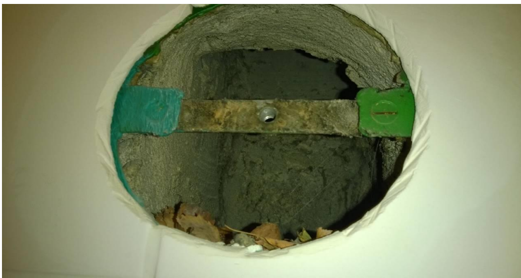
Kuva 20. Painovoimaisen ilmanvaihtojärjestelmän ilmanvaihtohormi
