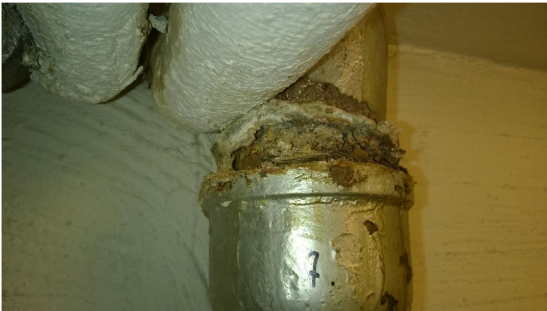
Kuva 9. Vuotava pystyviemäri kellarissa.
