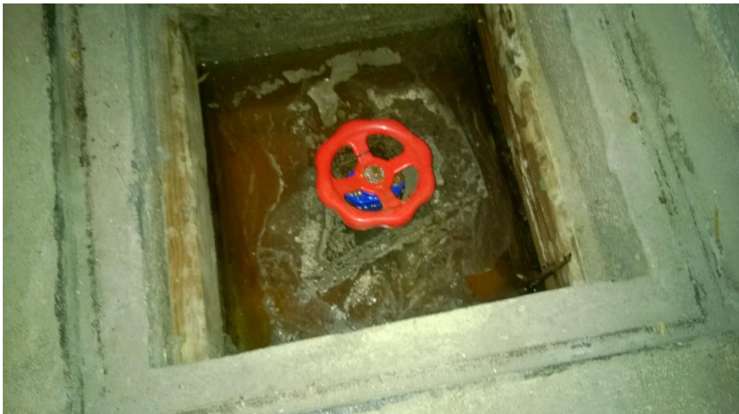
Kuva 7. Kellarissa padotusventtiilikaivoon on noussut pohjavesi.
