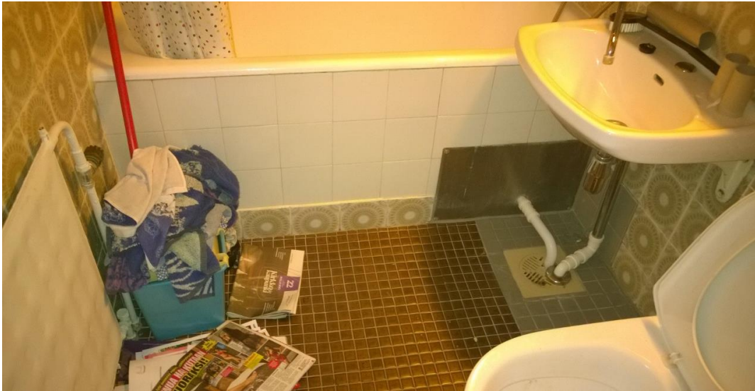
Kuva 22. Murattu kylpyamme, home- ja vesivahinkoriski.
