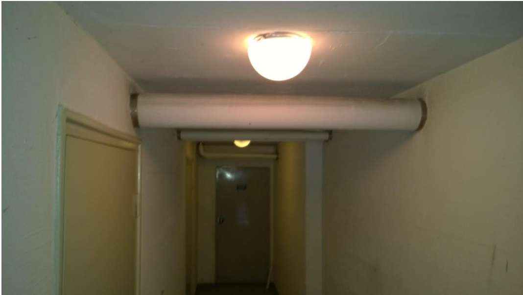
Kuva 8. Kellarin käytävän poikki kulkevat vesi- ja lämmitysputket.
