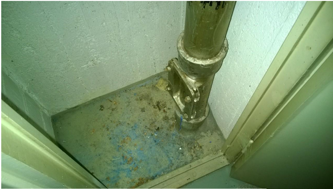
Kuva 2. Viemärin pystylinja on kellarissa komeron oven takana.
