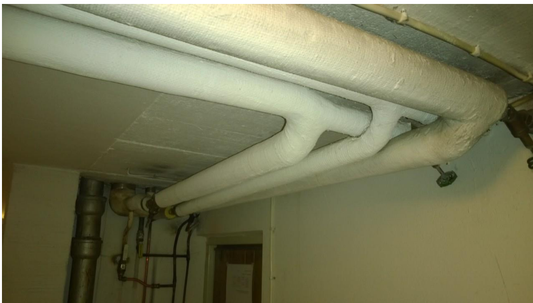
Kuva 3. Vesijohtojen eristeet sisältää asbestia.
