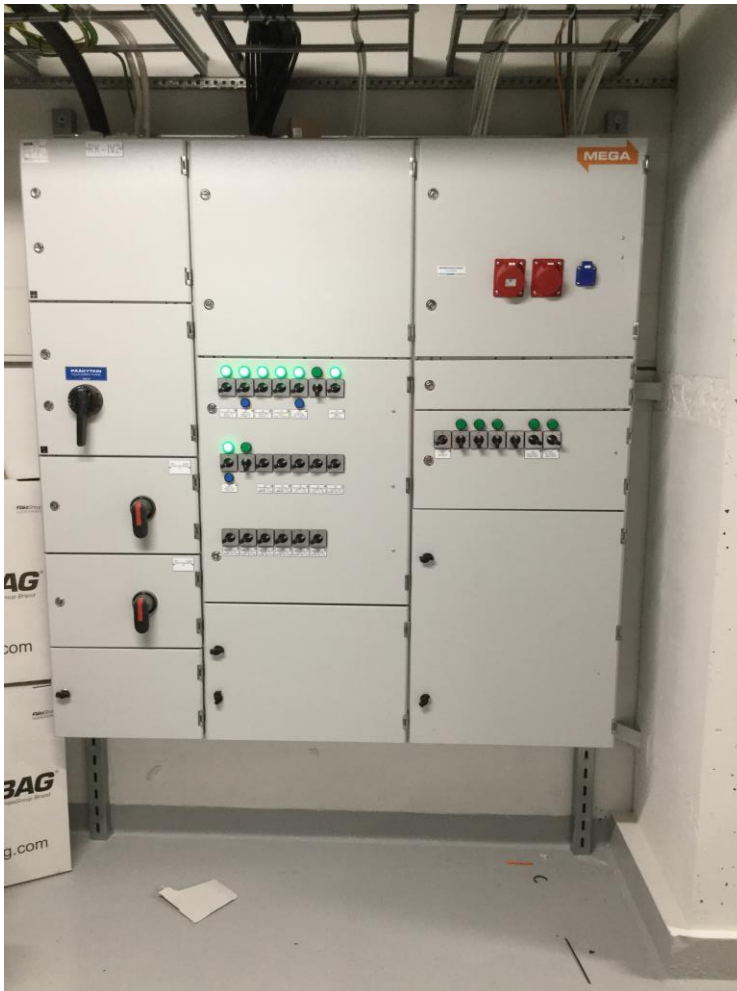
Kuva 7. Sähkön ryhmäkeskus ilmanvaihdon konehuoneessa
