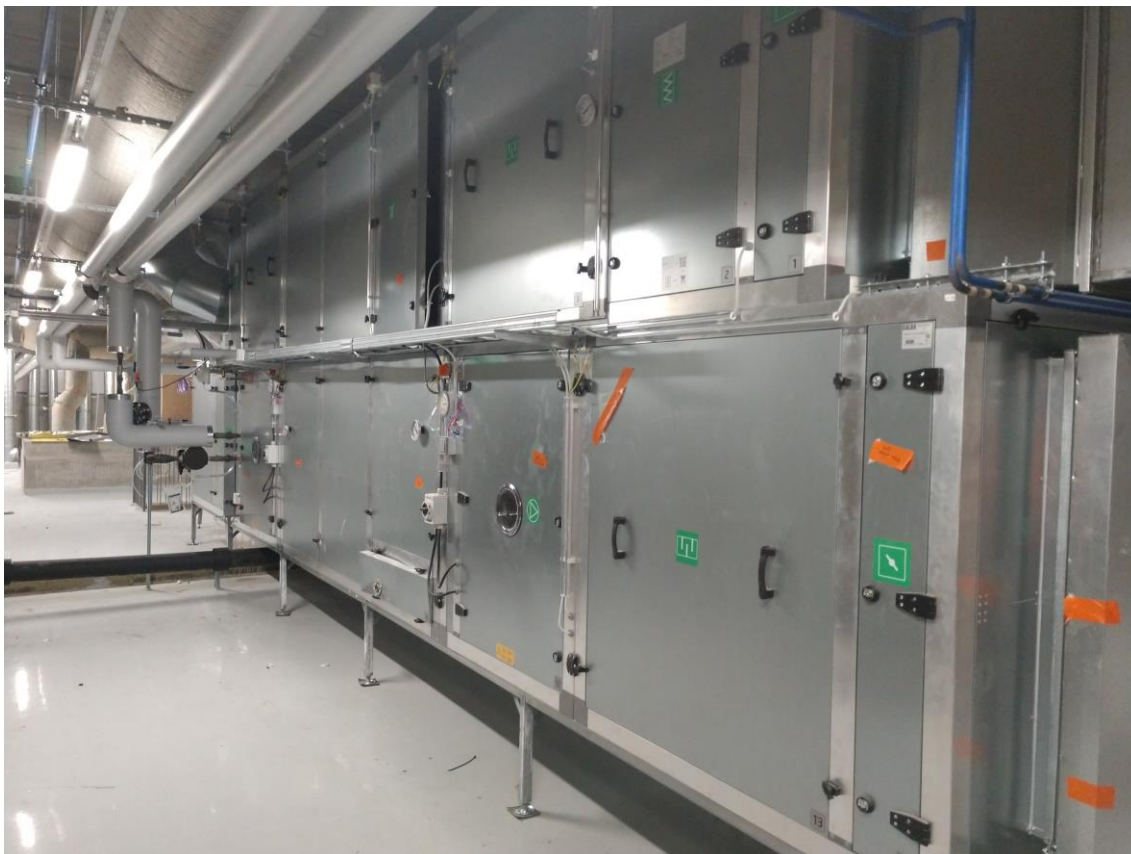
Kuva 2. Koneellisen tulo- ja poistoilman ilmanvaihtokone konehuoneessa
