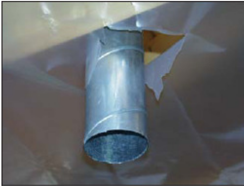
Kuva 2.3 Tiivistämätön höyrynsulun läpivienti (15.)
