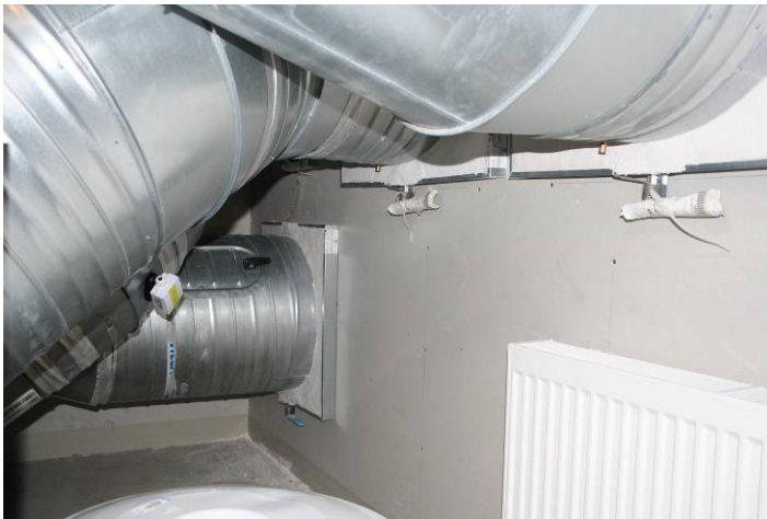
Kuva 6.2 Ilmanvaihtokanavien palopellit suljettuina
