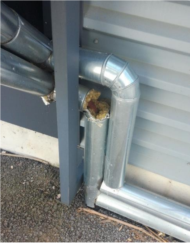
Kuva 27. Glykolilämmönsiirtimen putket (Koivula 2019).
