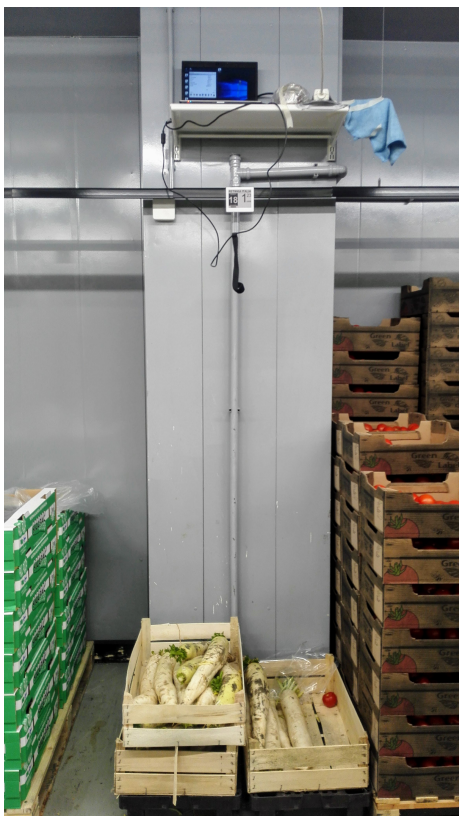
Kuva 5. Mittauspiste eteenin, lämpötilan ja suhteellisen kosteuden mittaamiseen.
