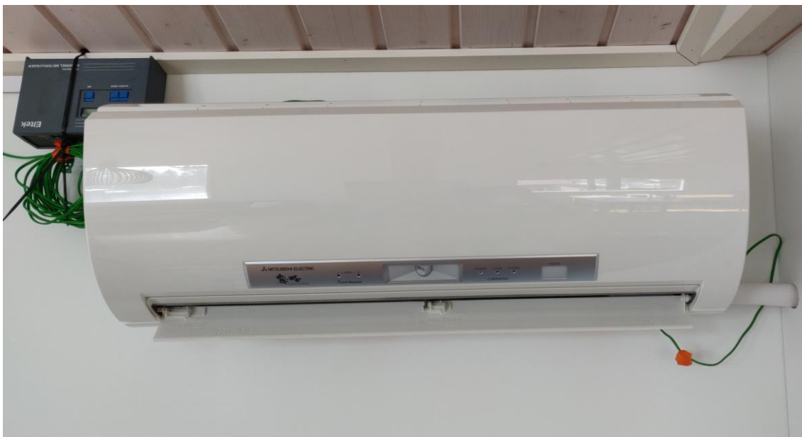
Kuva 13. Omakotitalon ilmalämpöpumpun sisäyksikkö.
