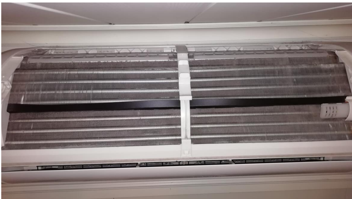
Kuva 11. Rivitalon ilmalämpöpumppu likaisena ilman suojakantta.
