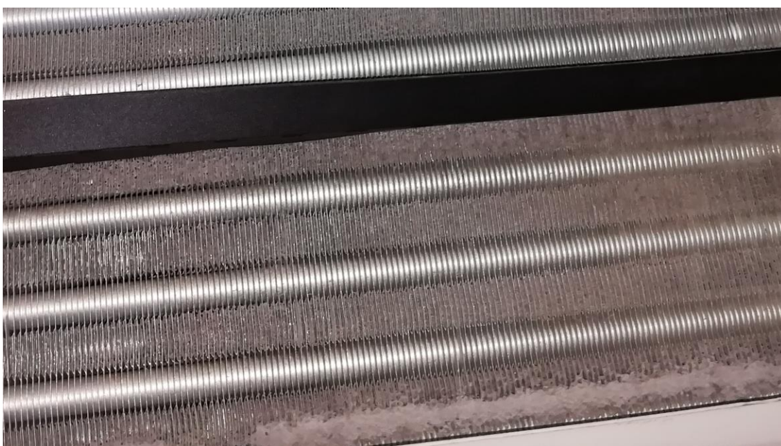
Kuva 12. Rivitalon ilmalämpöpumpun likainen kenno.
