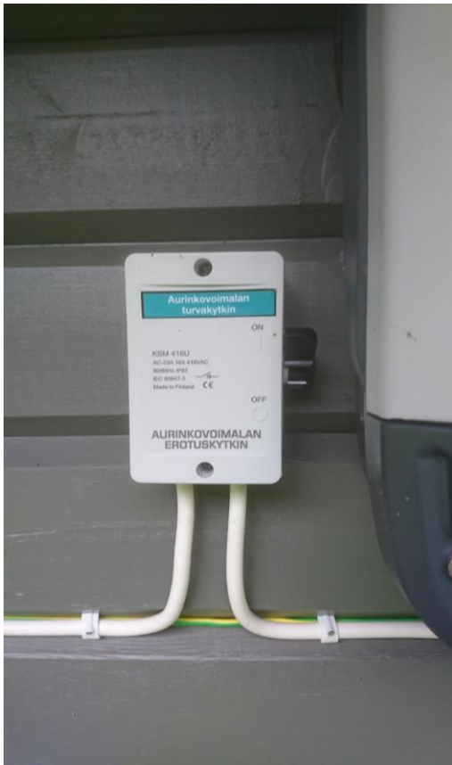
Kuva 11. Aurinkovoimalan erotuskytkin eli AC-turvakytkin.
