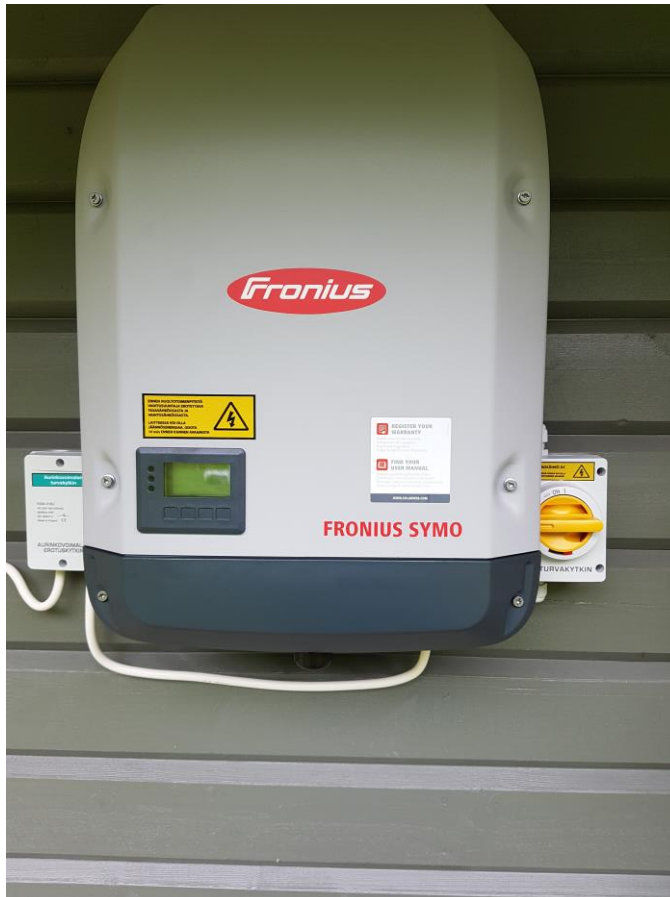
Kuva 15. Vasemmalla puolella AC-turvakytkin ja oikealla DC-turvakytkin.
