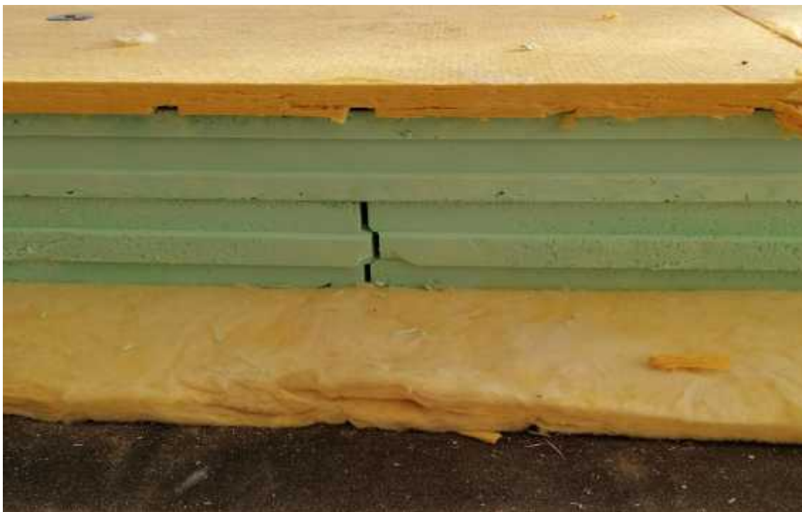
Kuva 5. Katon rakennekerrokset. Uuden katon rakennekerrokset; Höyrynsulku, tasausvilla, FF-PIR 100 mm + 120 mm ja uravilla. Kuvasta puuttuvat pintakermit. Tasausvilla ei kuulunut alkuperäiseen urakkaan.
