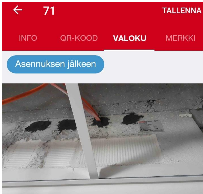
Kuva 8. Hiltin Documanagerilla kirjattu palokatko hormielementissä, jossa käytetty mustaa grafiittipohjaista massaa ja alempana näkyvissä pinnoitettua palokatkolevyä, joka on kitattu paloakryylillä. (Oma kuva Skanskan työmaalta)
