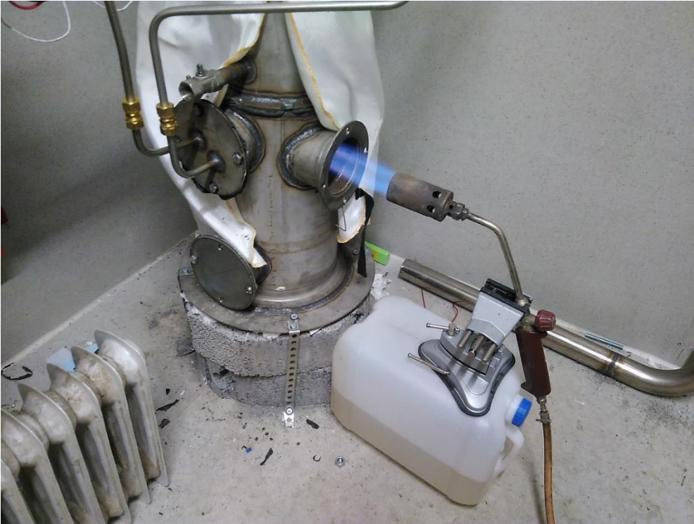
KUVA 78. Kattilan lämmitystä nestekaasulla
