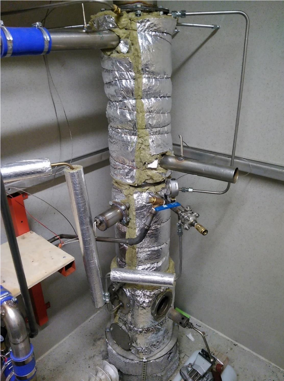
KUVA 69. Pääosin eristetty kattilakokonaisuus
