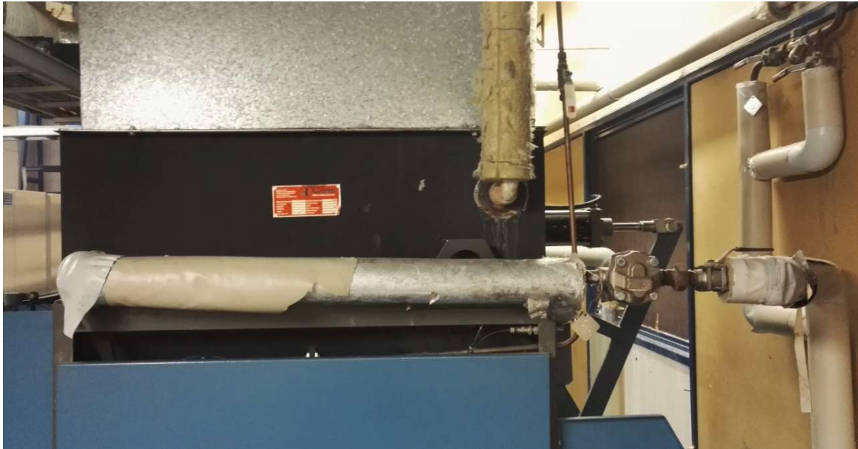
Figur 3 Torktumlarens värmväxlare med ingående ångrör och utgående kondensatrör.
