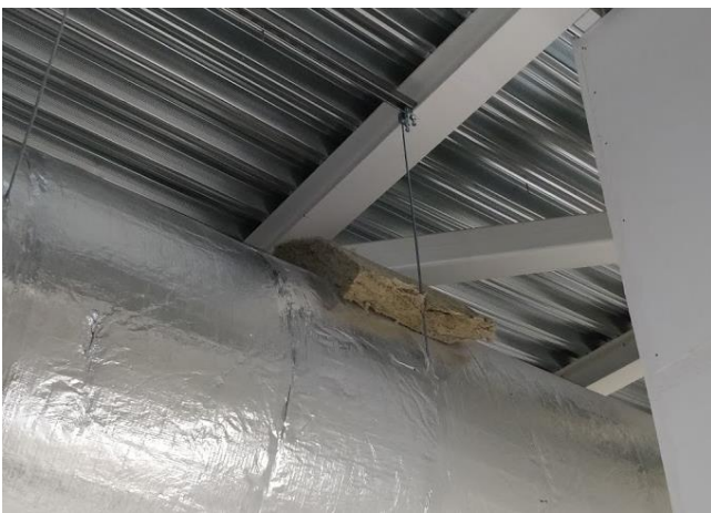
KUVA 7 Kanavan päälle jäänyt eristemateriaalin kappale
