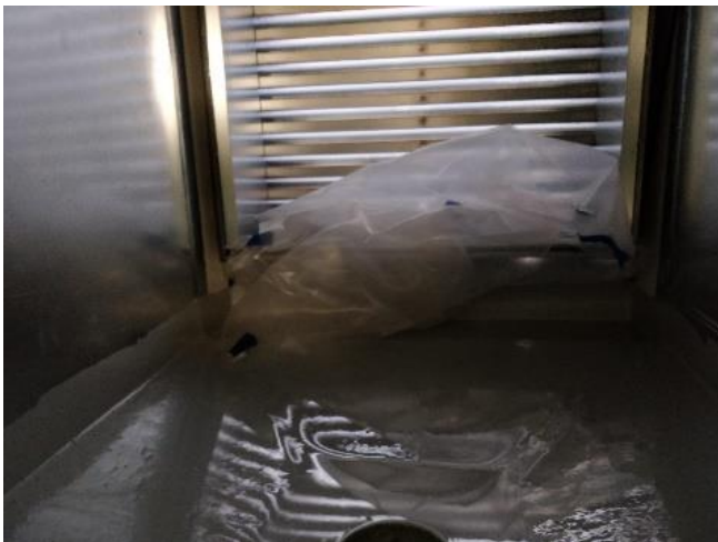
KUVA 13 Ulkoilmakammioon unohtuneita suojamuoveja
