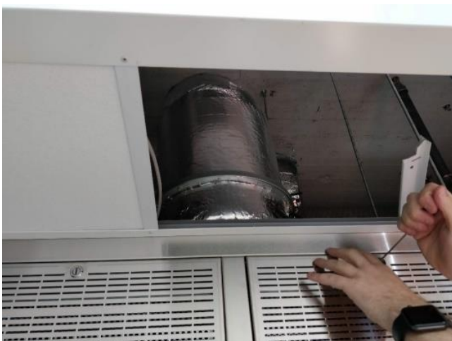
KUVA 16 Virheellisesti asennettu säätö- ja mittauslaite
