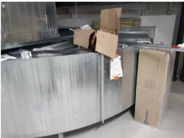
KUVA 9 Konehuoneeseen jätettyjä pahvilaatikoita ja muita rakennustarvikkeita
