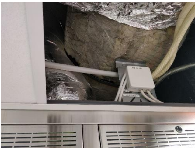
KUVA 15 Virheellisesti asennettu säätö- ja mittauslaite
