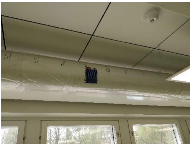
KUVA 3 Tuloilmalaitteen suojaus likaantumiselta
