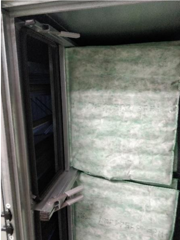
KUVA 14 Puuttuvat tuloilman suodattimet
