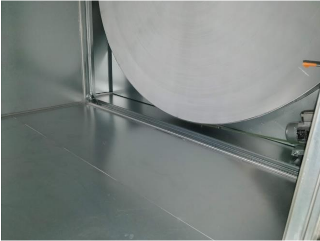
KUVA 5 Puhdistettu ilmanvaihtokoneen lämmöntalteenottolaitteen kammio
