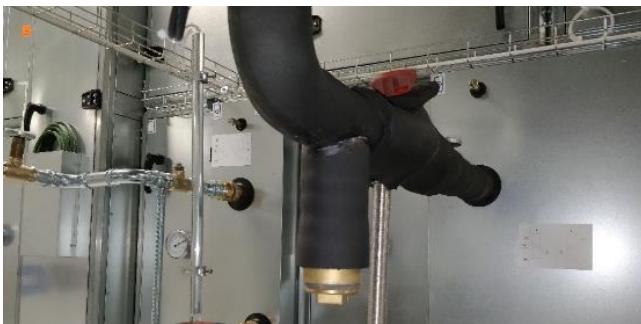
KUVA 11 Osa kondenssieristyksestä puuttuu jäähdytysvesiputkistosta
