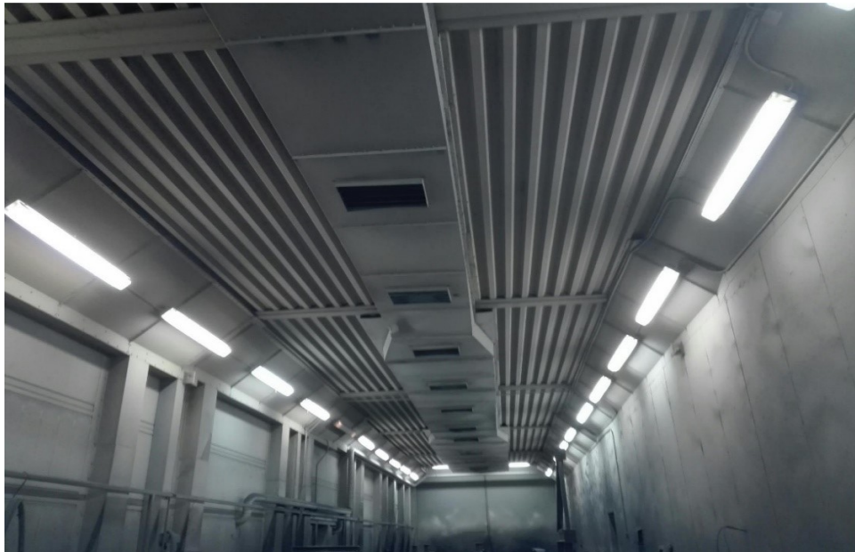
Kuvio 6. Maalaamon tuloilmakanavat
