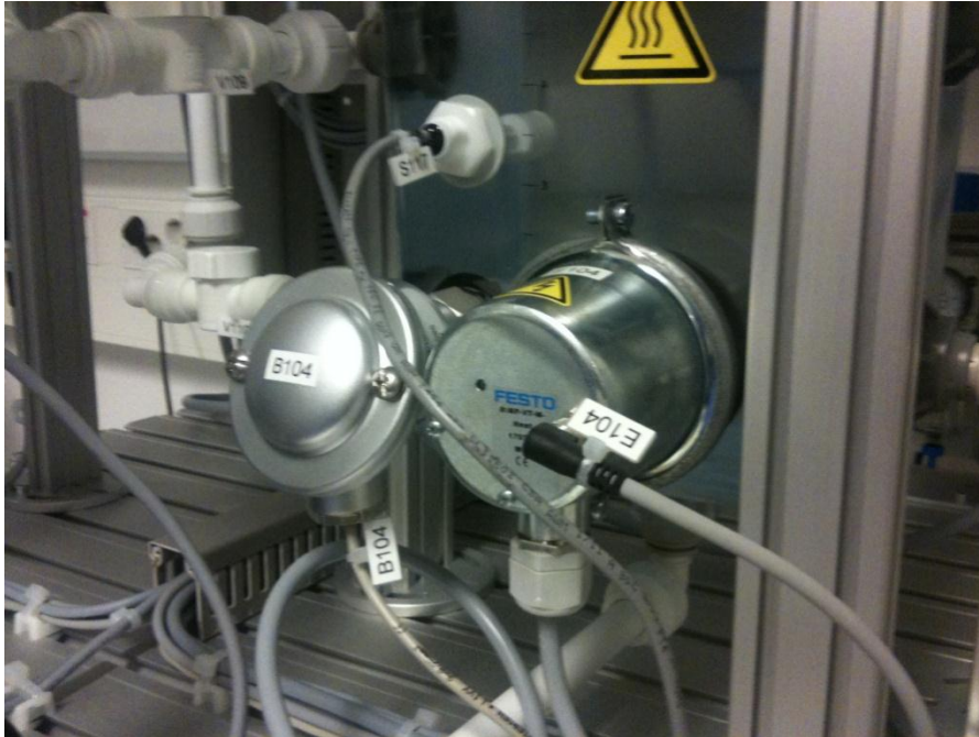
Kuva 11. Lämmityselementti E104, pinnantasanturi S117 sekä lämpötila-anturi B104.
