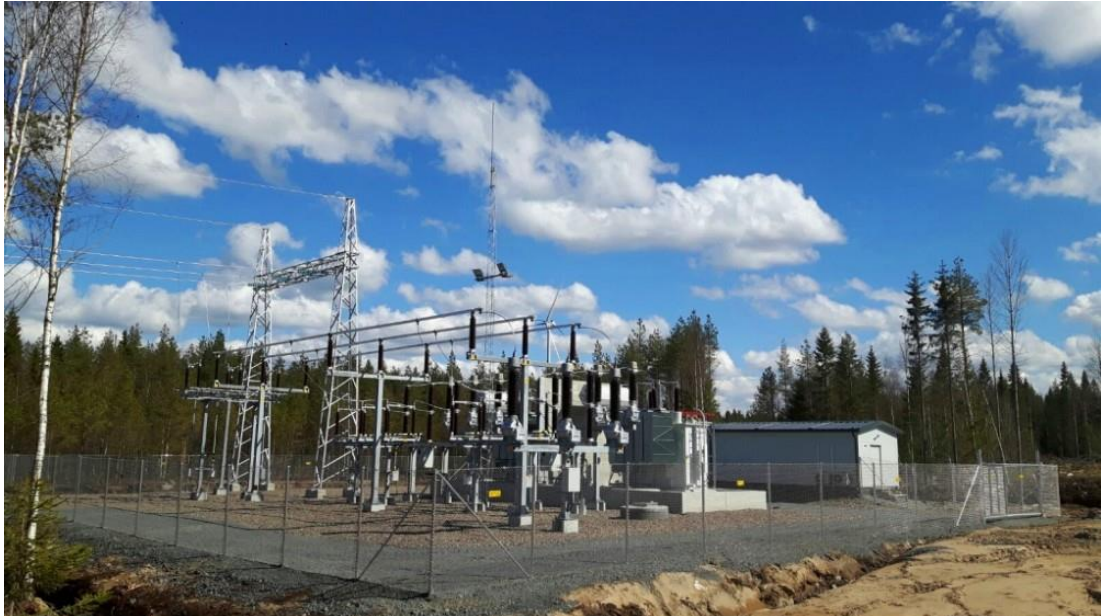
Kuva 14. Annankankaan 110/33kV sähköasema [11]
