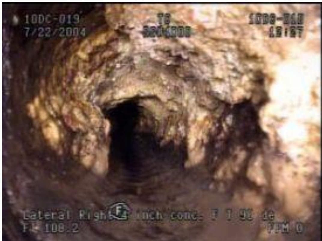
Kuva 12. Rasvatukos viemärissä [Fats, Oil and Grease]
