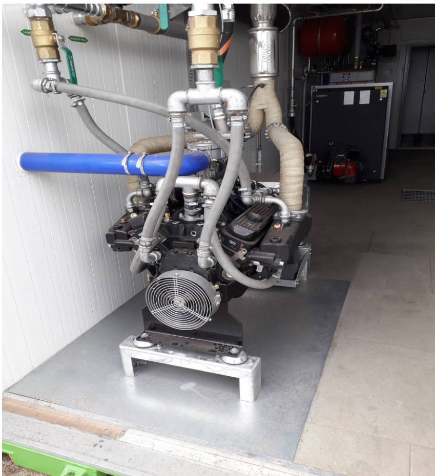
KUVA 2. Biokaasumoottori sähköntuotannossa. (Kuva, Tomi Pirttimäki)
