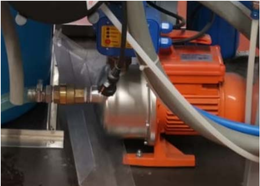
Kuva 4 Sähköpumppu on malliltaan Isku Jet 2R.
