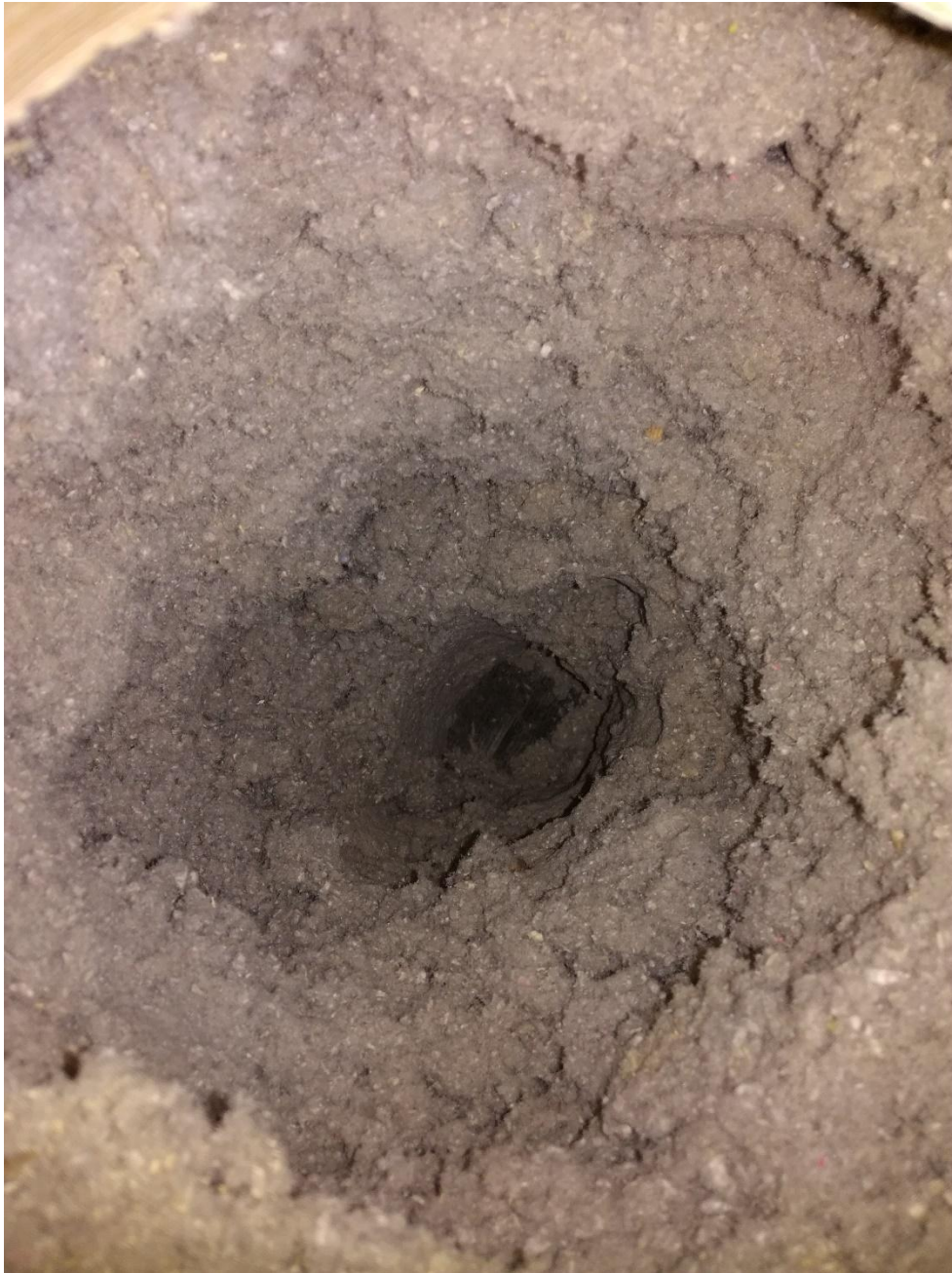
Kuva 7. Koulu-osan lattian eristettä. Eristekerros on pohjalta silminnähdessä kostea.
