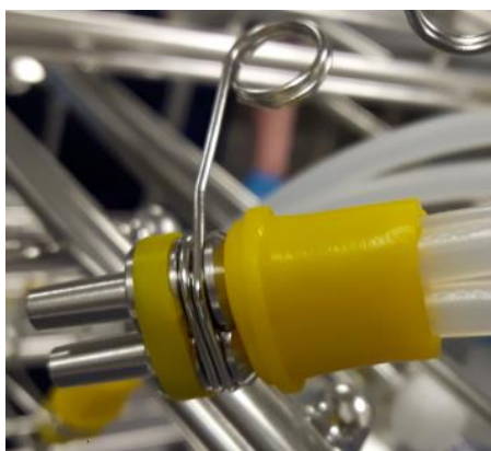
Kuva 17: Jousilangasta valmistettu liittimen kiinnitys ehjänä. (Kuva: Siltanen Markku)
