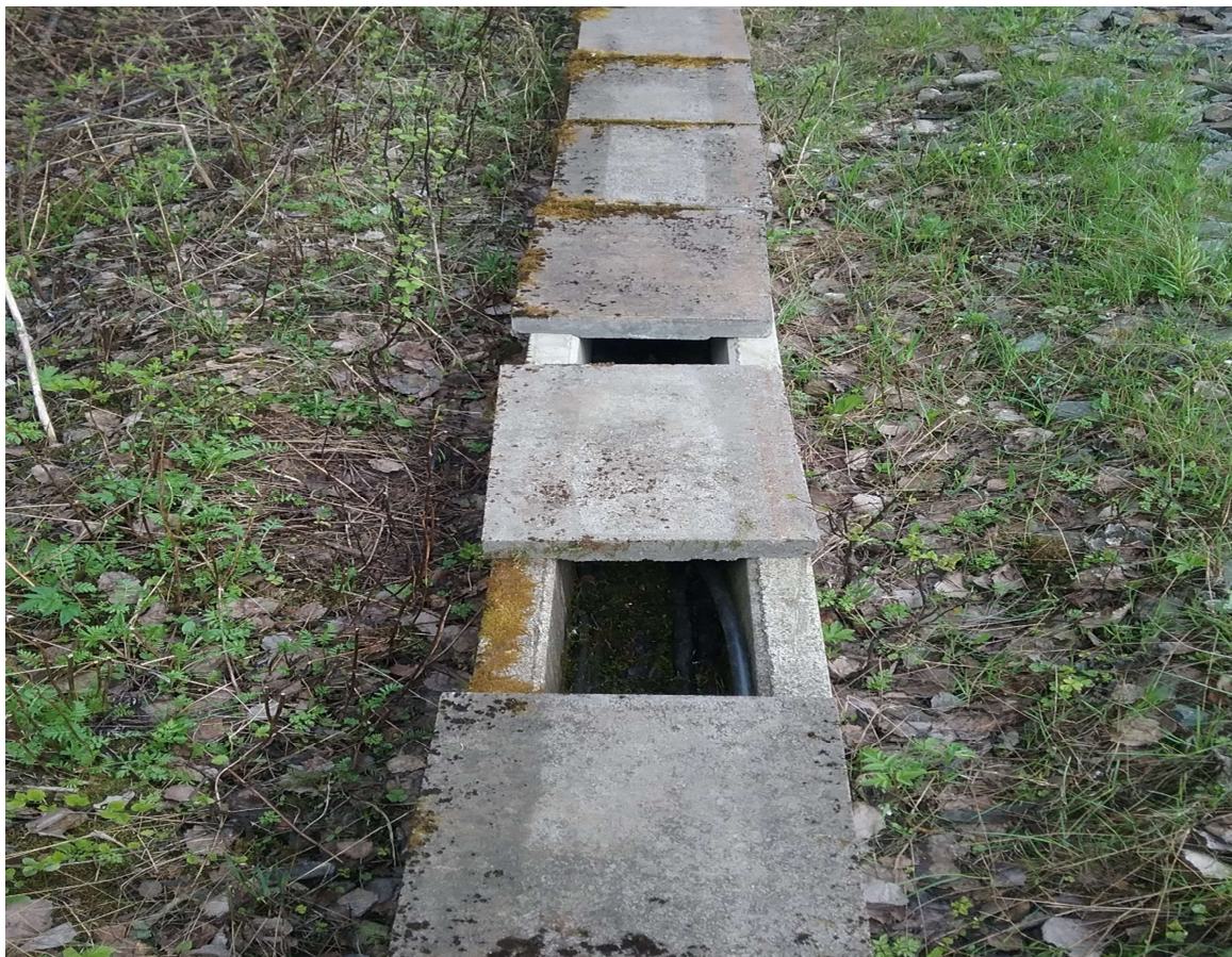
Kuva 2. Kaapelikourunkansi kohdassa 487+345 (Tammela 2019)
