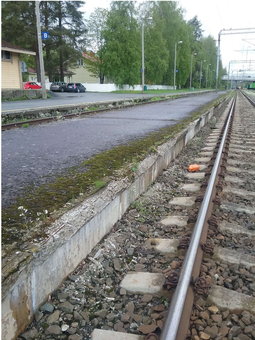
Kuva 9. Laiturinreuna murenee kohdassa 489+650 (Tammela 2019).
