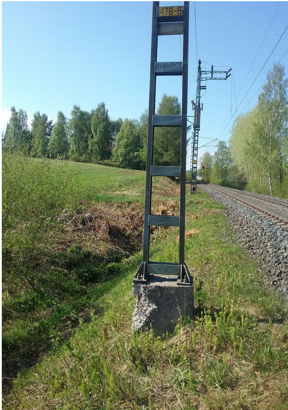
Kuva 4. Pylvään perustus murentunut kohdassa 478+525 (Tammela 2019)
