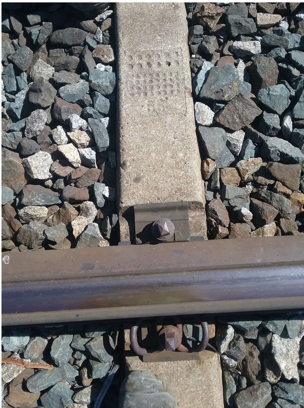
Kuva 6. Kiskonkiinnitys puuttuu kohdassa 533+532 (Tammela 2019).
