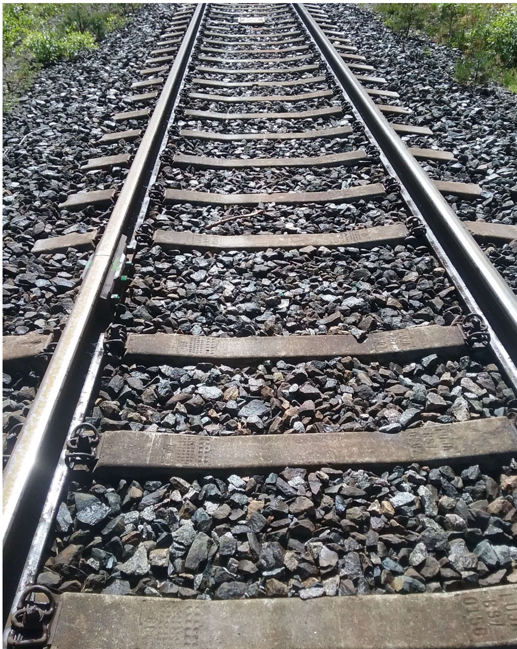
Kuva 7. Pölkkyväli liian suuri kohdassa 535+385 (Tammela 2019)
