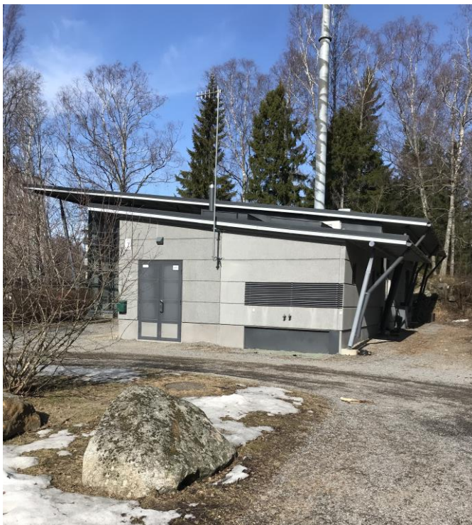
Kuva 9. Asuntomessualueella sijaitseva mikroturbiinilaitos.
