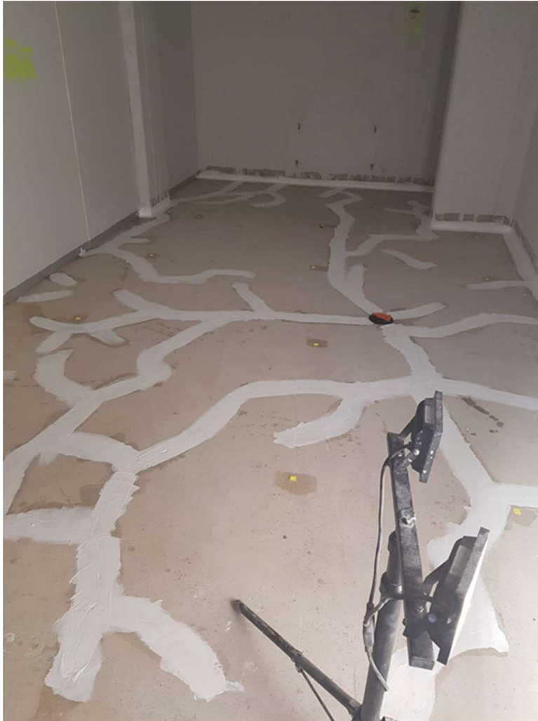
KUVA 9. Maanvaraisen lattian halkeamien tiivistämistä
