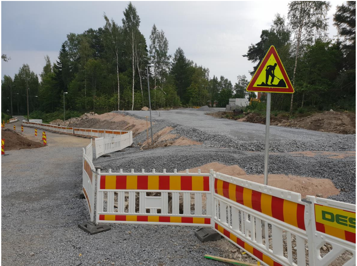
Kuva 8. Työaita ja sulkupuomi yhdistettynä väylän rajaamiseen
