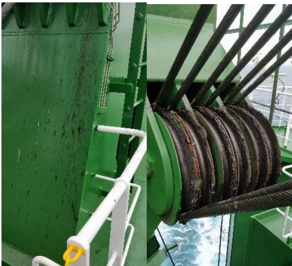
Kuva 10. Liiallisen rasvan käytöstä syntynyt sotku rampin rakenteisiin (Taimisto 2018).
