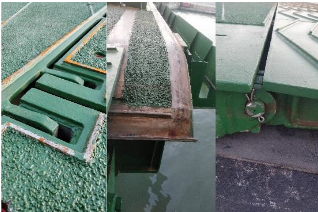
Kuva 12. Yleisiä vikakohteita rampissa, jolle suoritettiin tarkistus rampin laskun yhteydessä. Vasemmassa ja oikeassa reunakuvassa taiton saranoita ja keskikuvassa alareunan pokkaus (Taimisto 2018).
