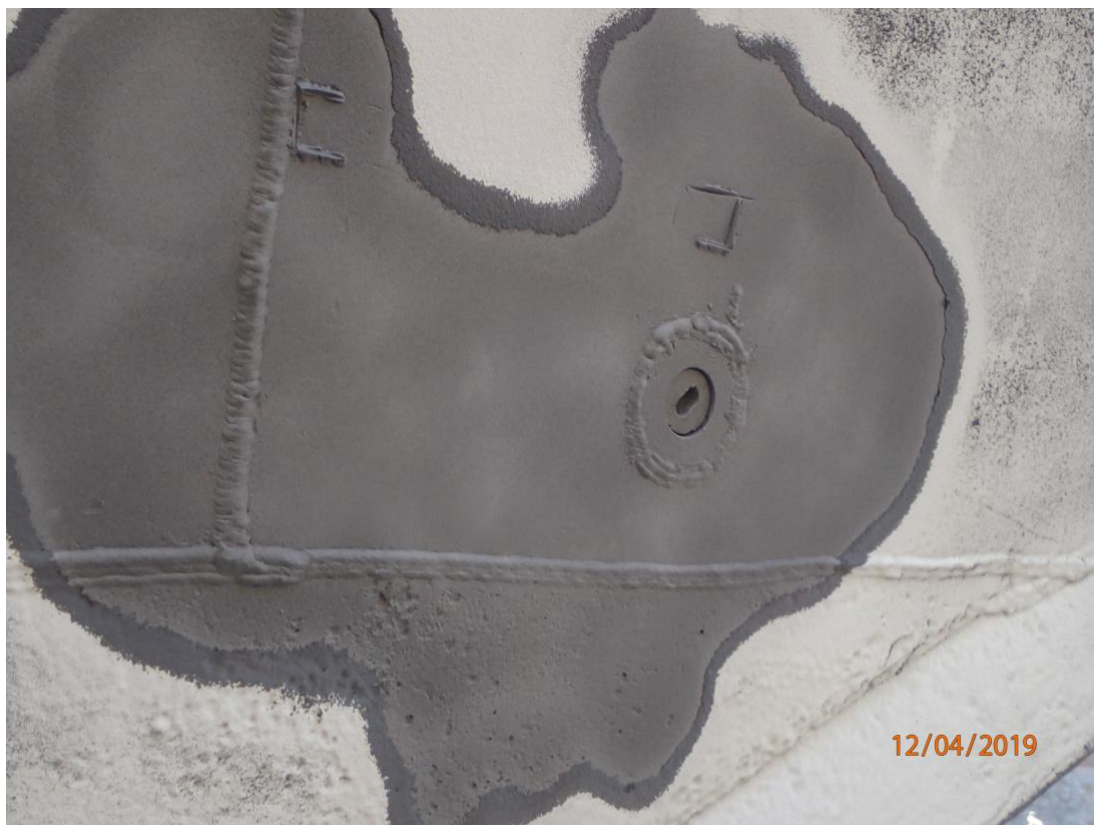
Kuva 5. Esimerkki suihkupuhdistuksen tasosta Sa 2 ½, puhdistettu alue Keihässalmen pohjassa keulassa. (Pekka Mattila, Forum Marinum 2019)
