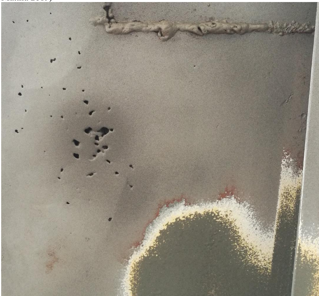
Kuva 6. Korroosiovaurio kansirakenteessa suihkupuhdistuksen jälkeen. (Ilkka Mattila 2019)
