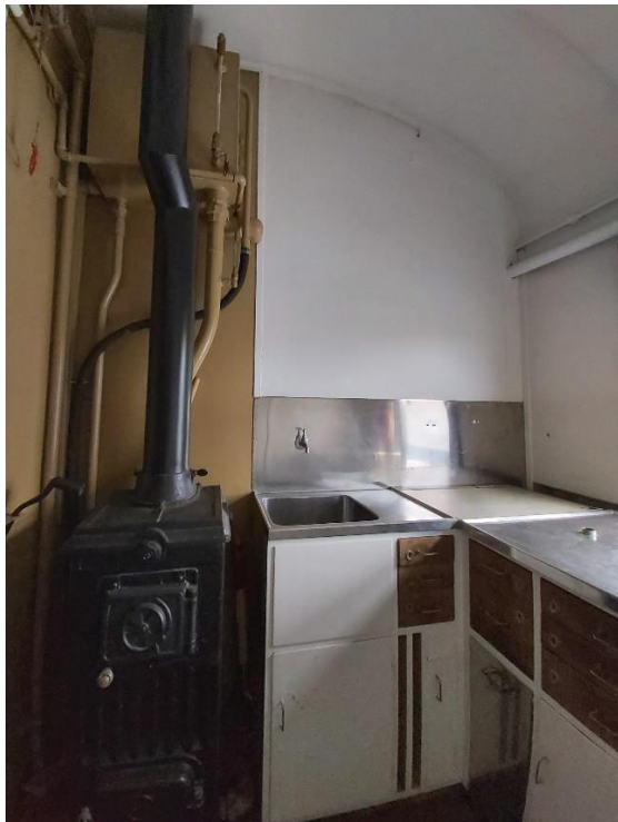
Kamiinan takana seinässä asbestia, ellei sitä ole poistettu aikaisempien muutostöiden yhteydessä.
