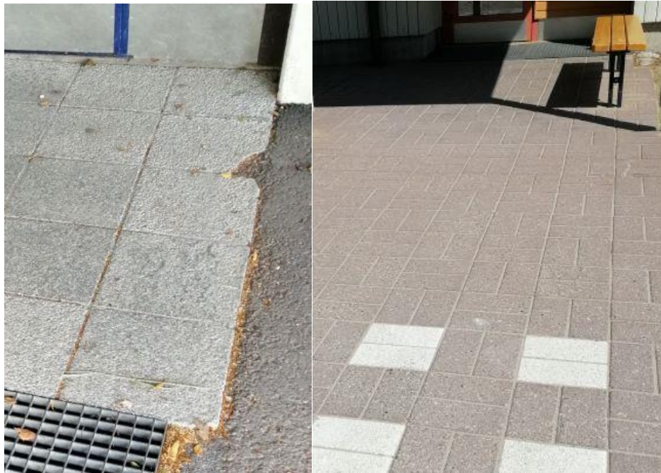
Kuva 6. Koulupihan sisääntulon huonokuntoinen laatoitus vasemmalla ja vastaavasti päiväkodin sisääntulon hyväkuntoinen betonikiveys oikealla.
