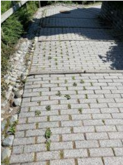
Kuva 7. Betonikivellä tehdyn käytävän reunat ovat alkaneet purkautua.
