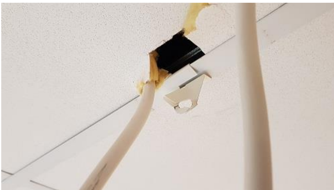
Kuva 12. Huonosti kiinnitetty valaisin.
