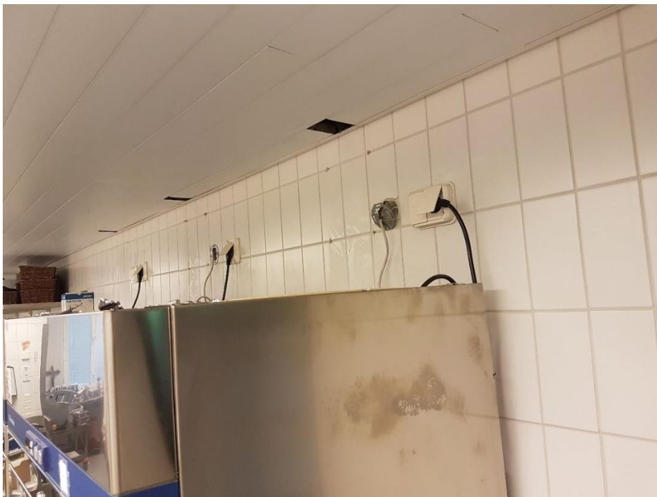
Kuva 6. Koulun keittiöstä puuttuu sähkörasioita.
