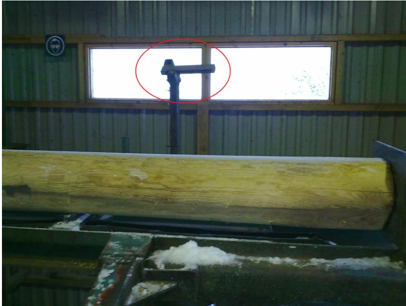
Kuva 8. Vastaanottokuljettimen pysäyttävä valokenno.
