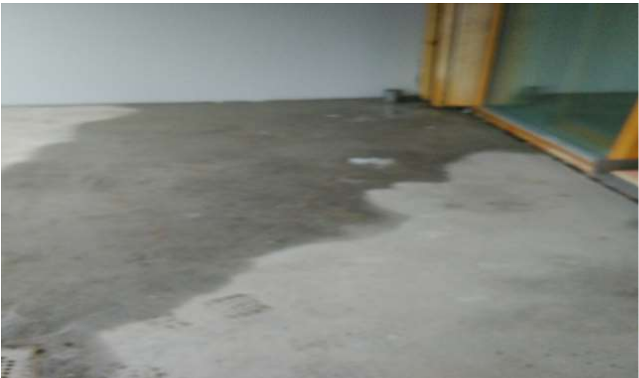
KUVA 2. Puutteellinen vedenohjausjärjestelmä. Riskinä veden ohjautuminen rakenteisiin.
