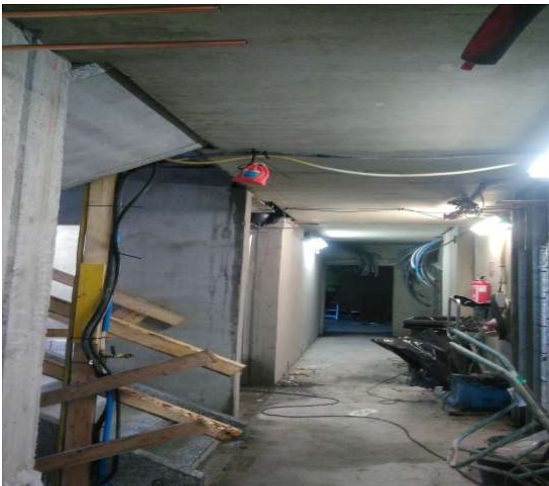
KUVA 9. Olosuhdeseuranta-anturi työmaalla (Hulpio 2019)
