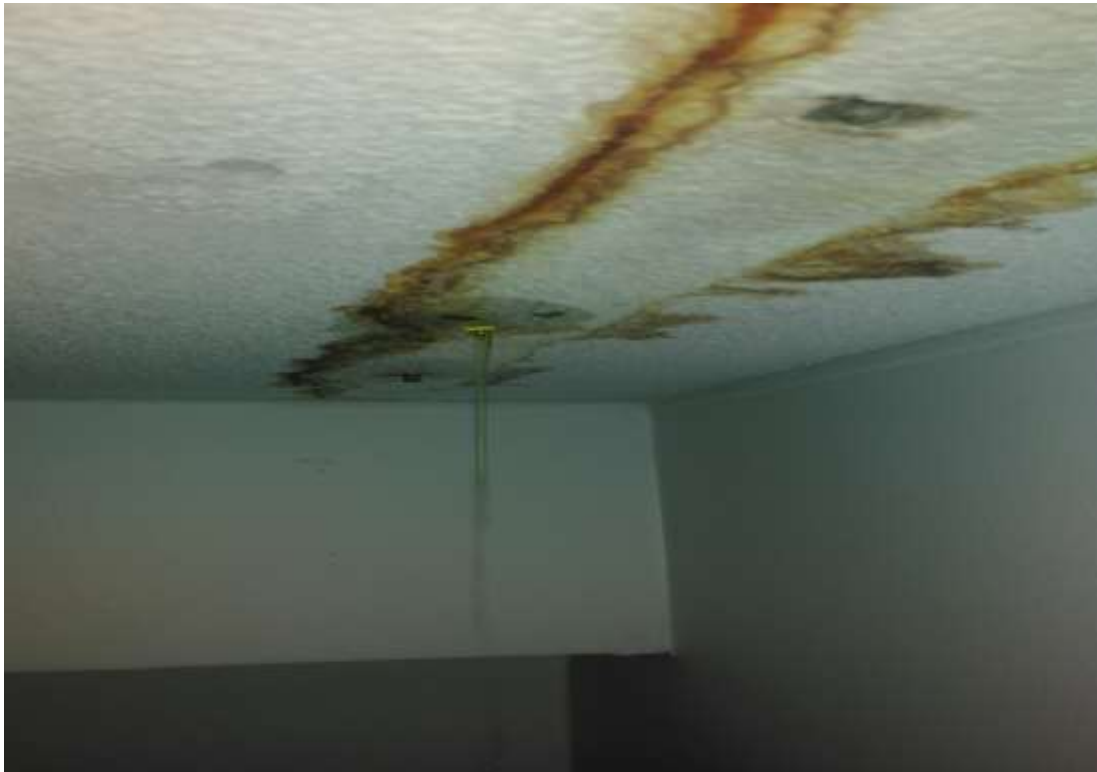
Kuva 11. Onteloon jäänyt vesi rakentamisvaiheessa. Vuosikorjauksessa vesi-poistettu (Hulpio 2019)
