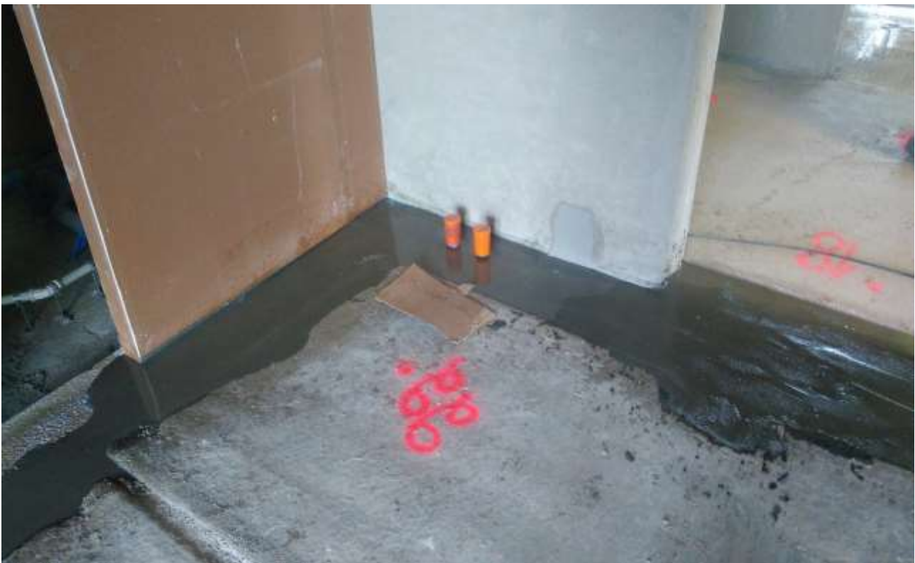
KUVA 5. Epäonnistunut mittaus. Oikaisutasoite kaadettu mittaustulppien ympärille.
