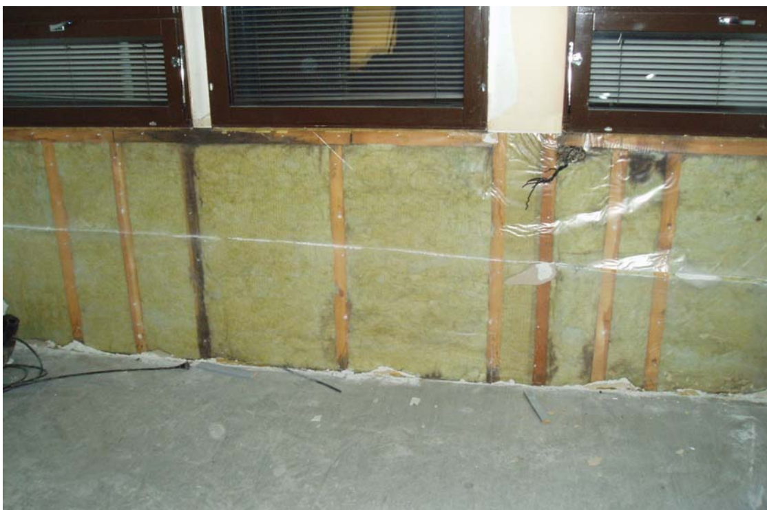
KUVA 4. Ikkunapellitusten puutteellisuudesta johtunut homevaurio (Pöyhönen 2008)
