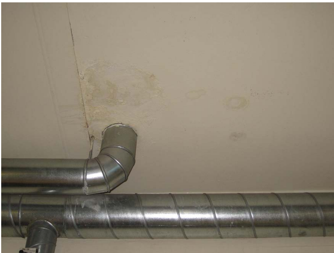
KUVA 3. Kosteuseristysten puutteellisuudesta aiheutunut kosteusvaurio välipohjassa.
