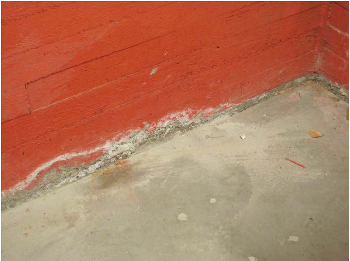
KUVA 2. Kalkkihärmä kellarin seinässä viittaa puutteelliseen salaojitukseen
