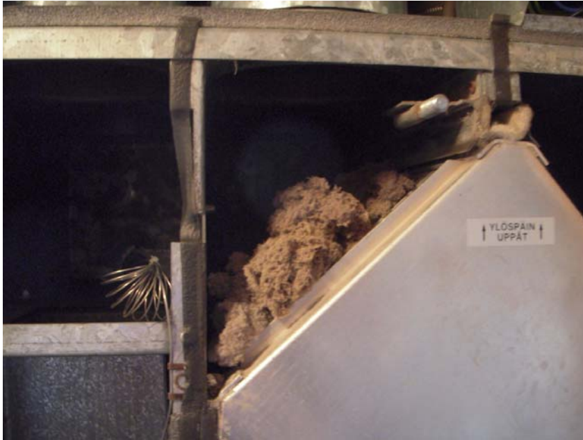
KUVA 5. Poistoilmakanavissa ollutta pölyä
