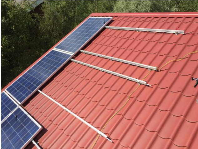
Kuva 7. Loivan katon aurinkopaneelikiinnitys [Mikä on aurinkopaneelien hinta ja kuinka paljon sähköä ne tuottavat].
