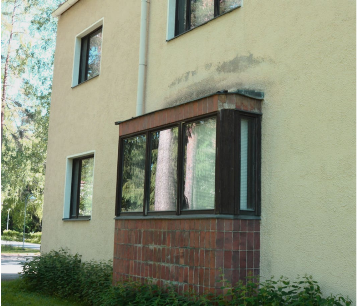
KUVA 28. Erkkerin tiililaattojen ja rappauksen vaurio (Laura Hakola)
