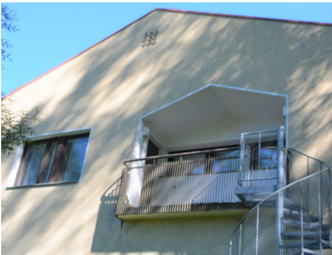
KUVA 29. Parvekkeen reunassa näkyvä rappausvaurio (Laura Hakola)
