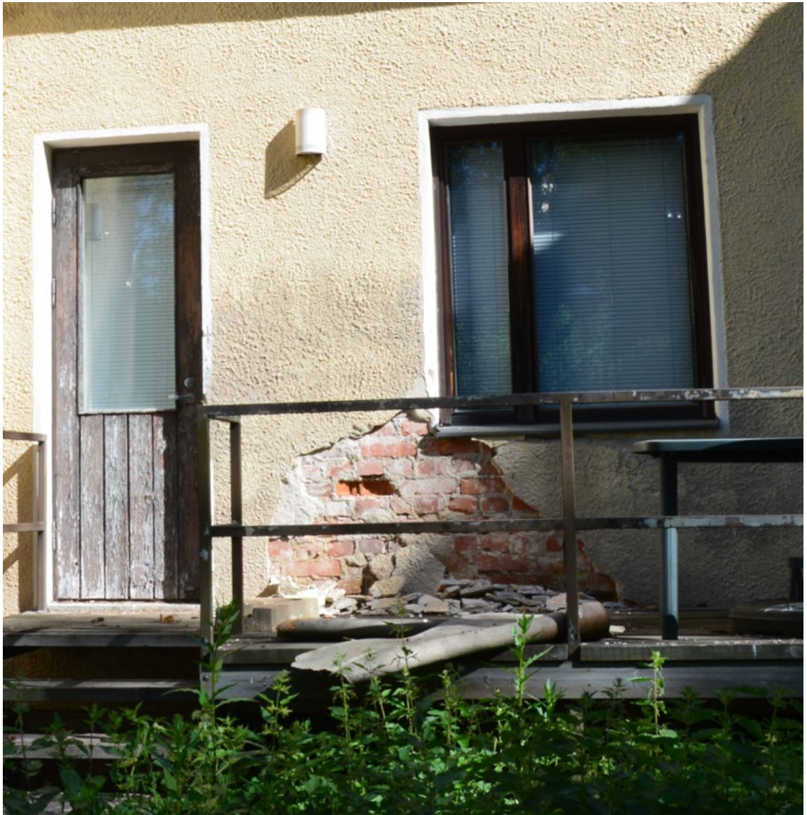
KUVA 30. Terassin kohdalla oleva rappausvaurio (Laura Hakola)
