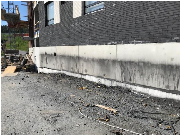
Kuva 19. Muurauslaastilla tahriintunut sokkeli
