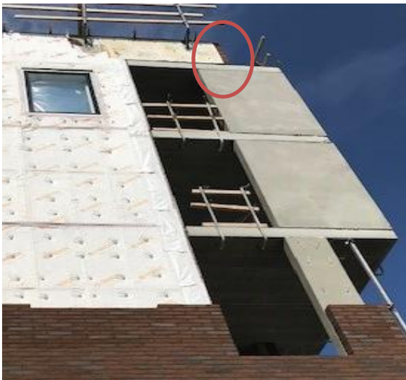
Kuva 21. Liikuntasauha väärässä kohdassa
