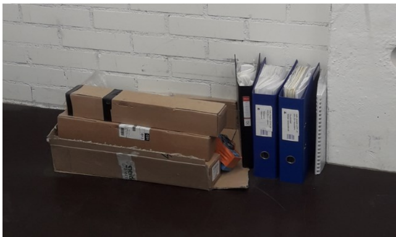
Kuva 10. Dokumentit kansioissa, sekä varasulakkeet laatikoissa lattialla.
