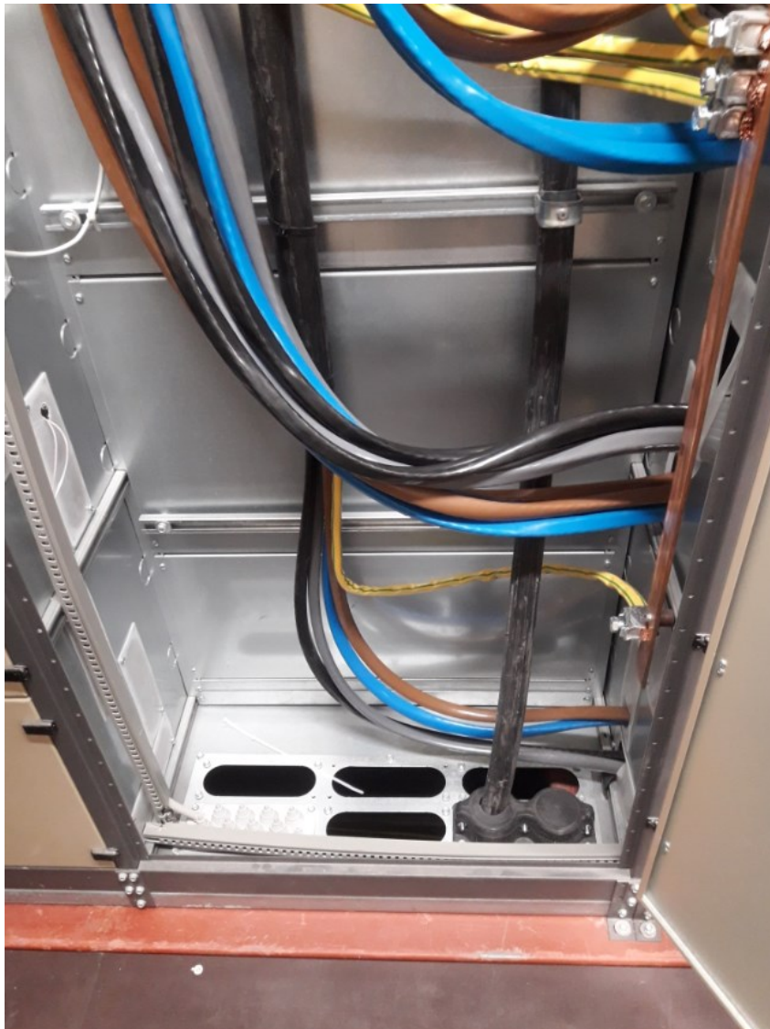
Kuva 15. Avoimet läpiviennit keskuksen sisällä.
