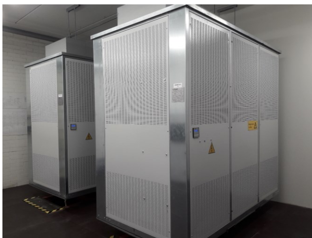
Kuva 8. Muuntajat T1 ja T2.
