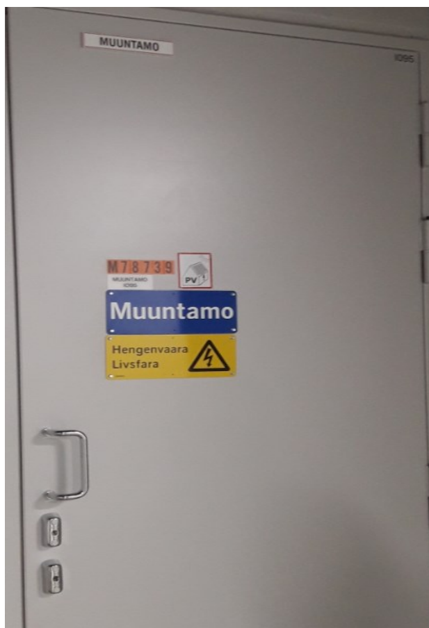
Kuva 7. Muuntamotiloihin johtava ovi.
