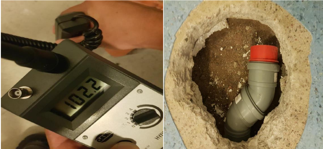
Figur 13. Ytfuktmätare indikerar på fukt. Figure 14. Figur 14. Jordnära betong.
