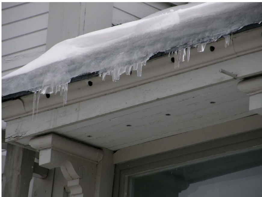
Kuva 8. Jäätä on muodostunut räystäälle ullakon lämpövuotojen vuoksi. Räystääseen on tehty reikiä ullakon tuuletuksen tehostamiseksi.
