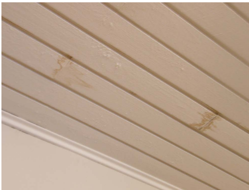
Kuva 18. Lautakatto, joka on 2. kerroksen kokoushuoneessa. Katossa on jälkiä vesikatteen vuodoista.
