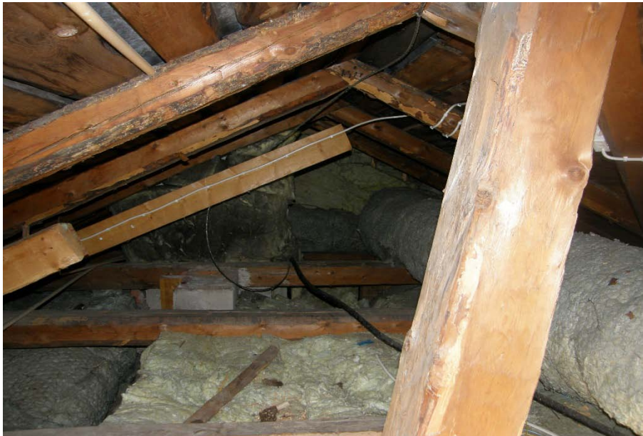
KUV 7a. Yläpohja ja ullakko, peltikaton alla ei ole aluskatetta.
