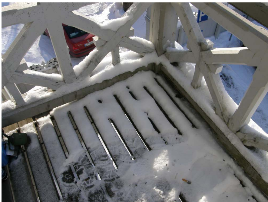
Kuva 9. Päätyparvekkeessa on rakolattia, jonka läpi vesi valuu seinälle.
