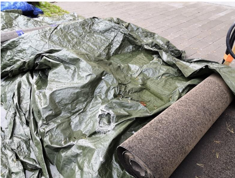
KUVA 2. Vesi pussiutunut suojapeitteen päälle
