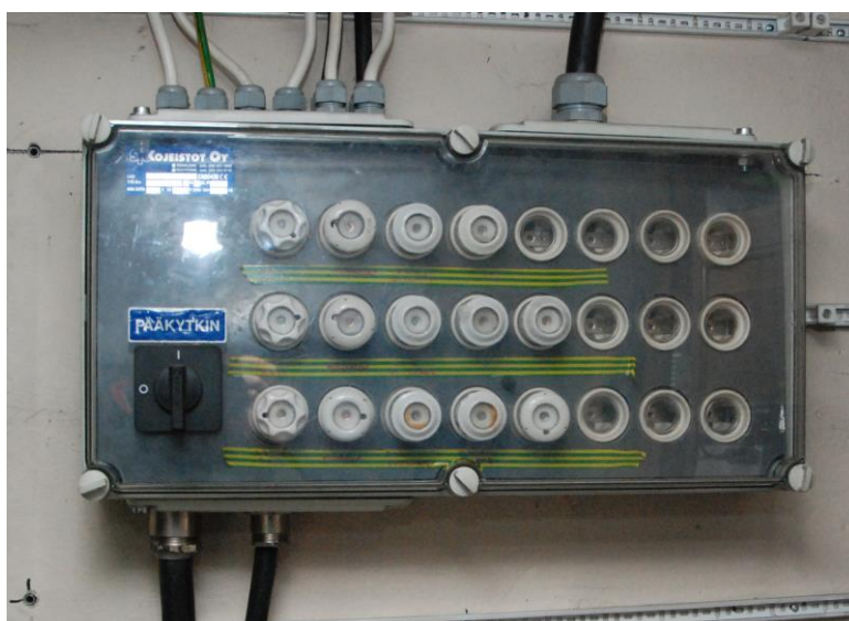
KUVA 1. Kohteen nykyinen pääkeskus
