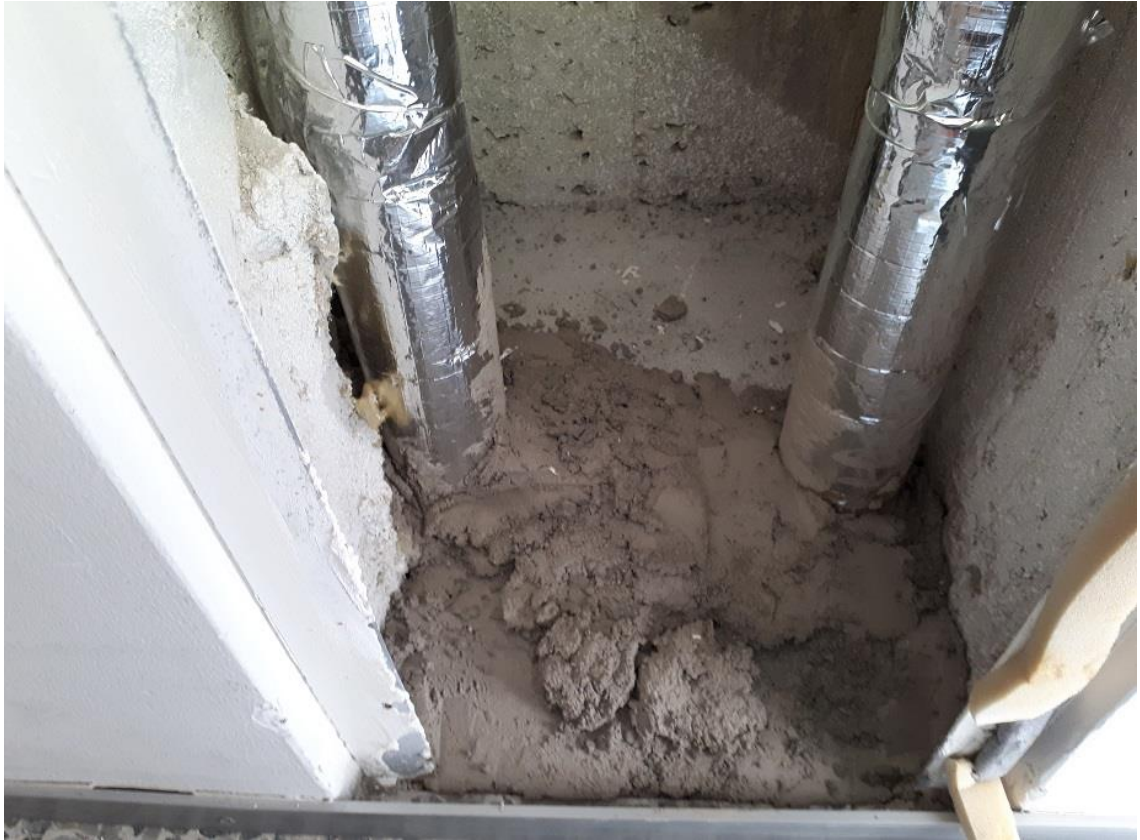
Kuva 8. Kaksoispilari etulevy poistettuna tarkistusta varten. Pohjan tasaisuus ei ole riittävä tiivistys- työtä varten.
