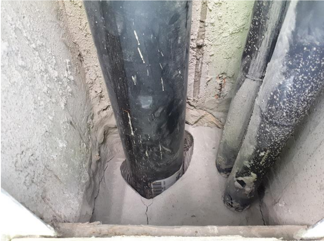
Kuva 3. Geberit muoviviemäriputki ja tiiviisti kiinnittämättä jätetty palomaton kääre jättää pilarin pohjan auki. Katso kuva 2.
