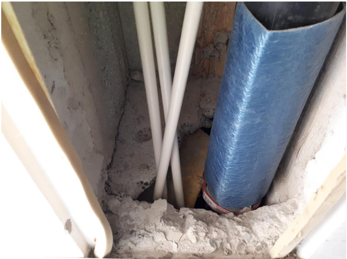
Kuva 6. Palokatkon läpiviennin tekemiseen tarvittava palokatkokääre ja sen alla näkyy palomansetti. Näiden asentamisen jälkeen voidaan pohja valaa palokatkomassalla.
