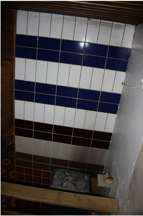
KUVA 1. Saunan seinää ennen saneerausta
