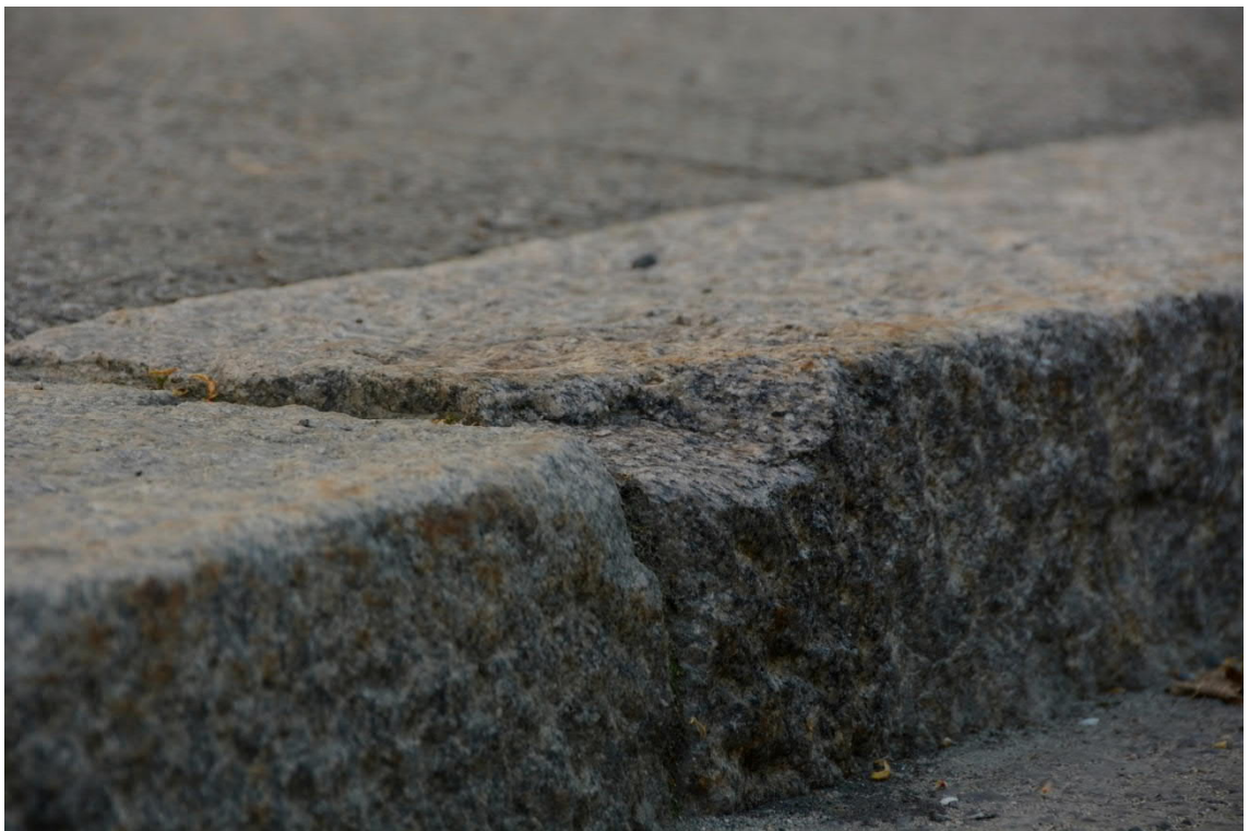
Kuva 8. Lohkeama kiven kulmassa
