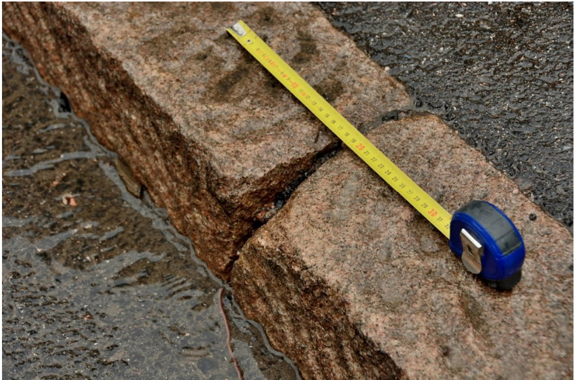
Kuva 22. Reunoiltaan pyöristynyt lohkeama
