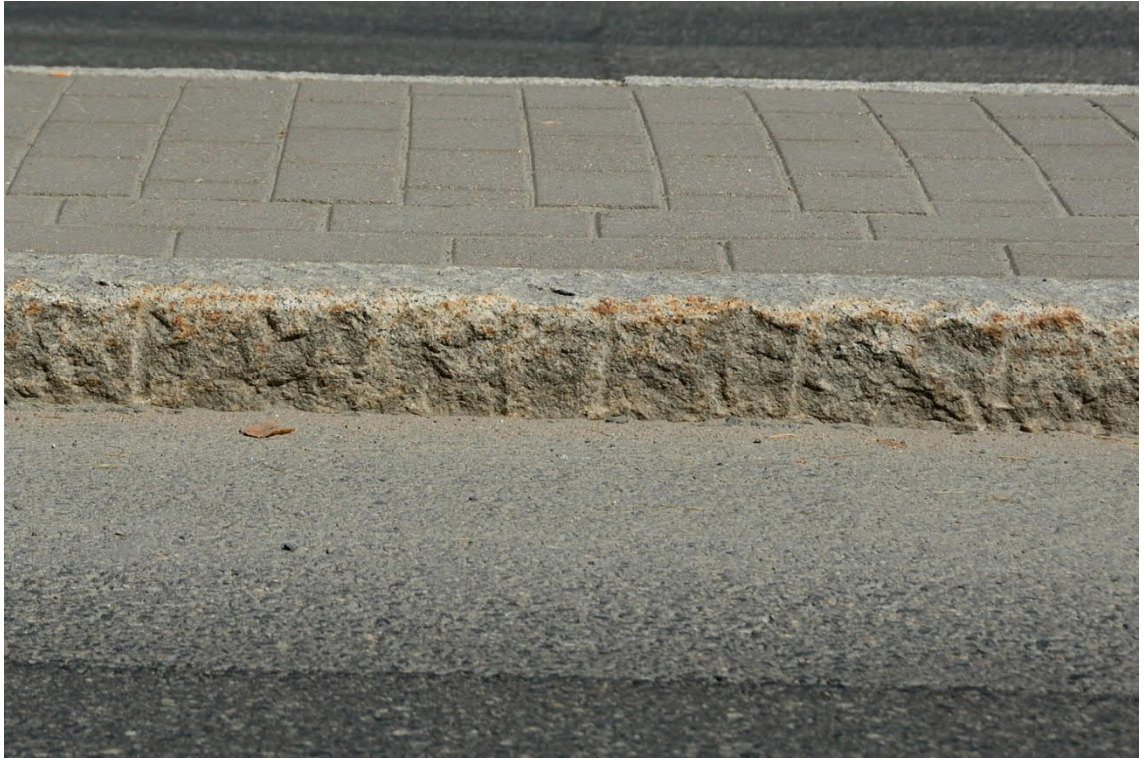
Kuva 13. Pystysuuntaiset poranreiät kiven etupinnassa, ruostevärjäytymä
