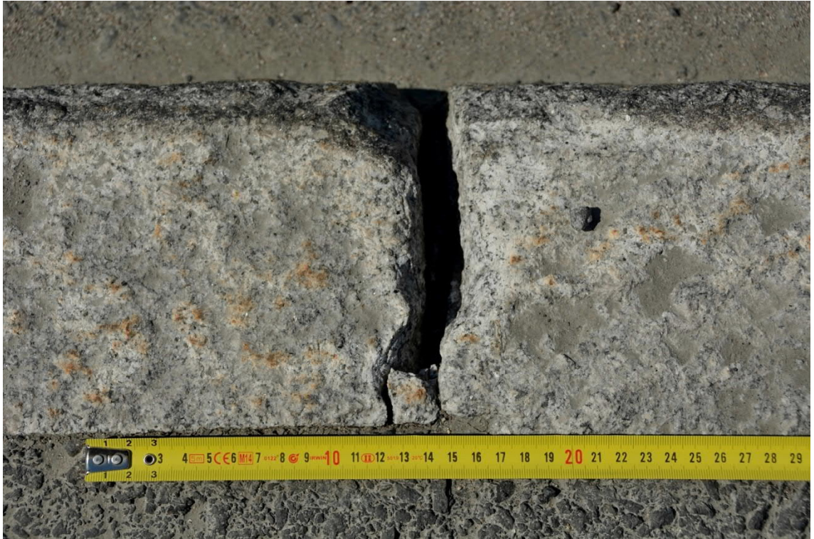
Kuva 9. Etusärmän pyöristyminen, ruostevärjäytymä ja kiven pään lohkeilu
