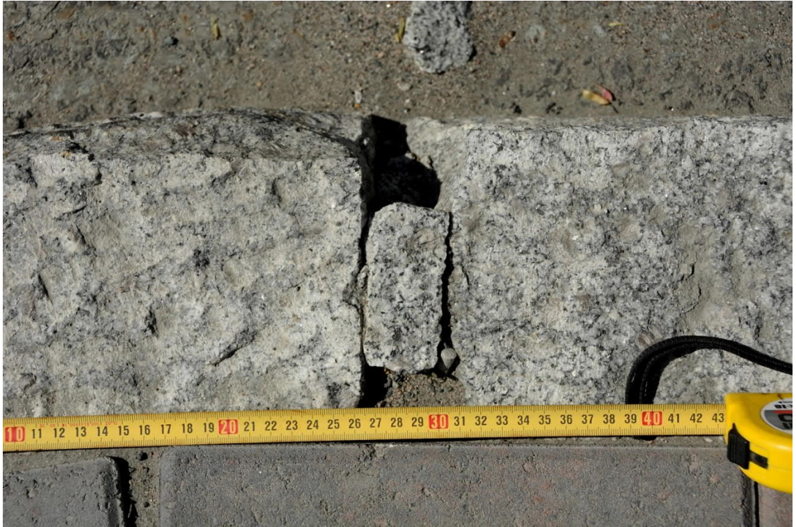
Kuva 11. Kiven päästä lohjennut kookas kappale
