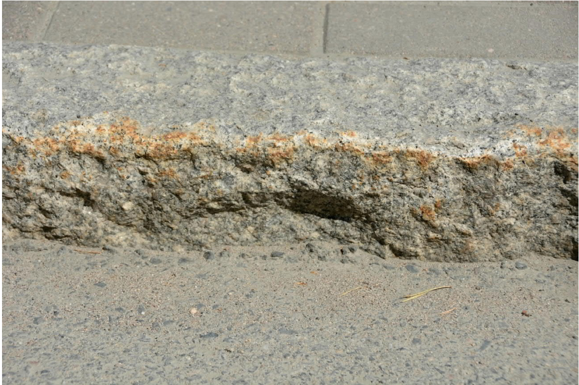
Kuva 15. Merkittävä epätasaisuus kiven etupinnan viimeistelyssä, ruostevärjäytymä
