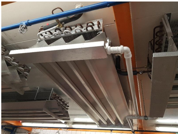
Kuvat Höyrytimissä havaittuja puutteita ja kuvia vanhoista höyrytimistä.
