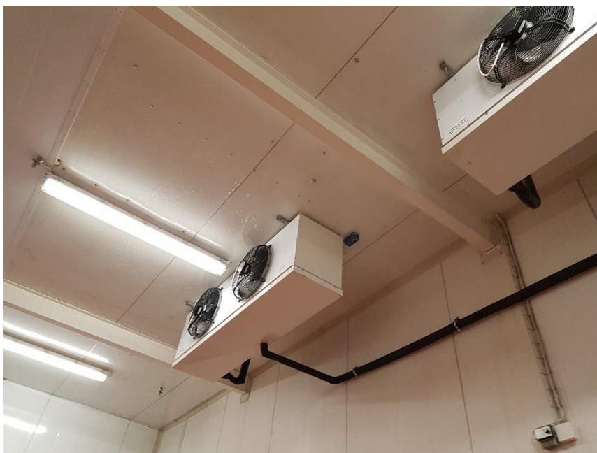
Kuva Pakastehuoneiden höyrystimiä on uusittu 10 vuoden sisällä
