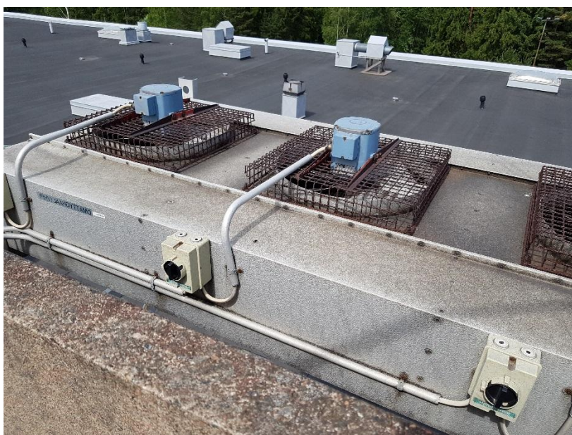
Kuvat katolla olevia lauhduttimia.
