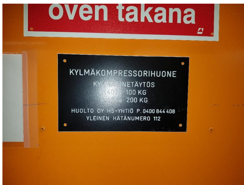
Kuvat konehuoneen kylmäainemerkintä virheellinen, tilassa ei ole R407A kylmäainetta.
