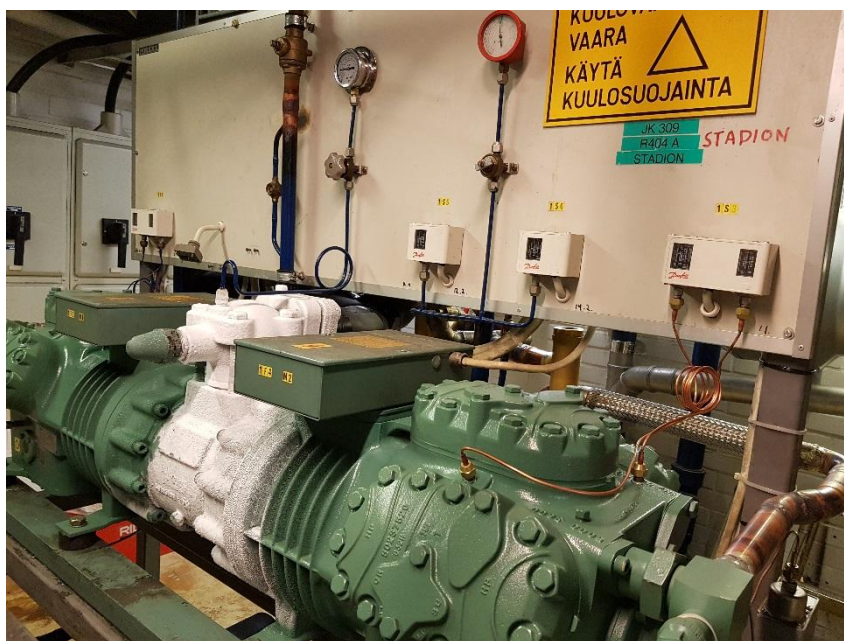
Kuva Stadion jäähdytyskoneikko, R404A jäädyyttää kompuran takaosaa. Voi johtua alkuperäisistä paisuntaventtiileistä, jotka suunniteltu eri kylmäaineelle.
