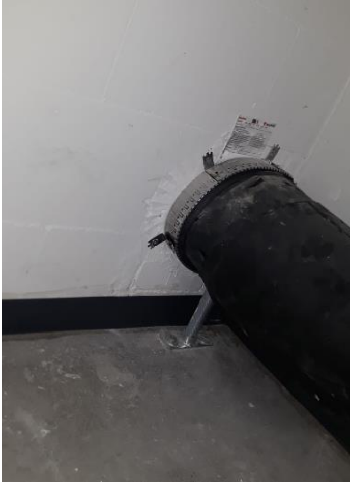
Kuva 5. PVC-viemäriputken läpiviennin palokatko palokatkomansetilla.
