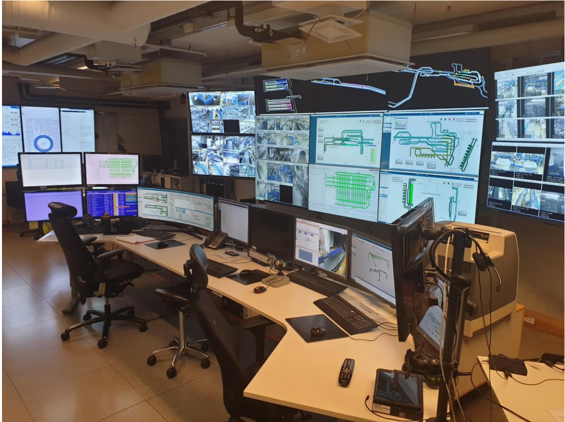
Kuva 3. Operaattorien työpiste. Taka-alalla suurkuvanäyttö, jonka keskellä yleisnäkymä valvomo-ohjelmistosta (SCADA) sekä sen yläreunassa VISUALIZER.
