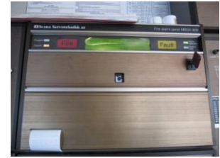
palohälytyskeskuksen paneeli komentosillalla
