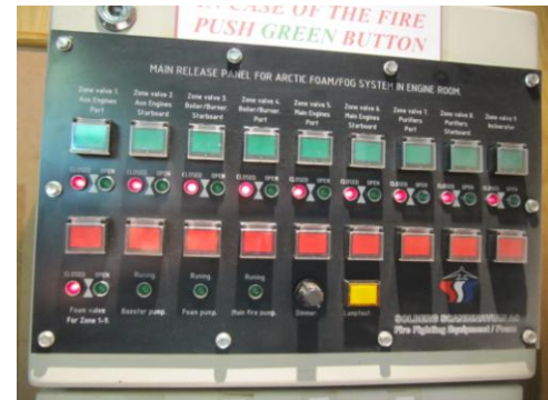
Paikallinen paneeli ja paneeli konevalvomossa
