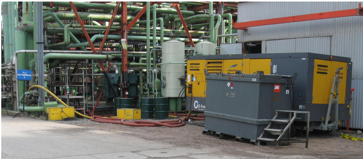
Kuva 6. Käyttöhyödyke 1 paineilmakompressori sekä liitos.
