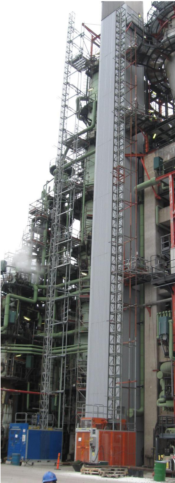
Kuva 21. DA-2401 sekä DC-2401 työmaahissit.
