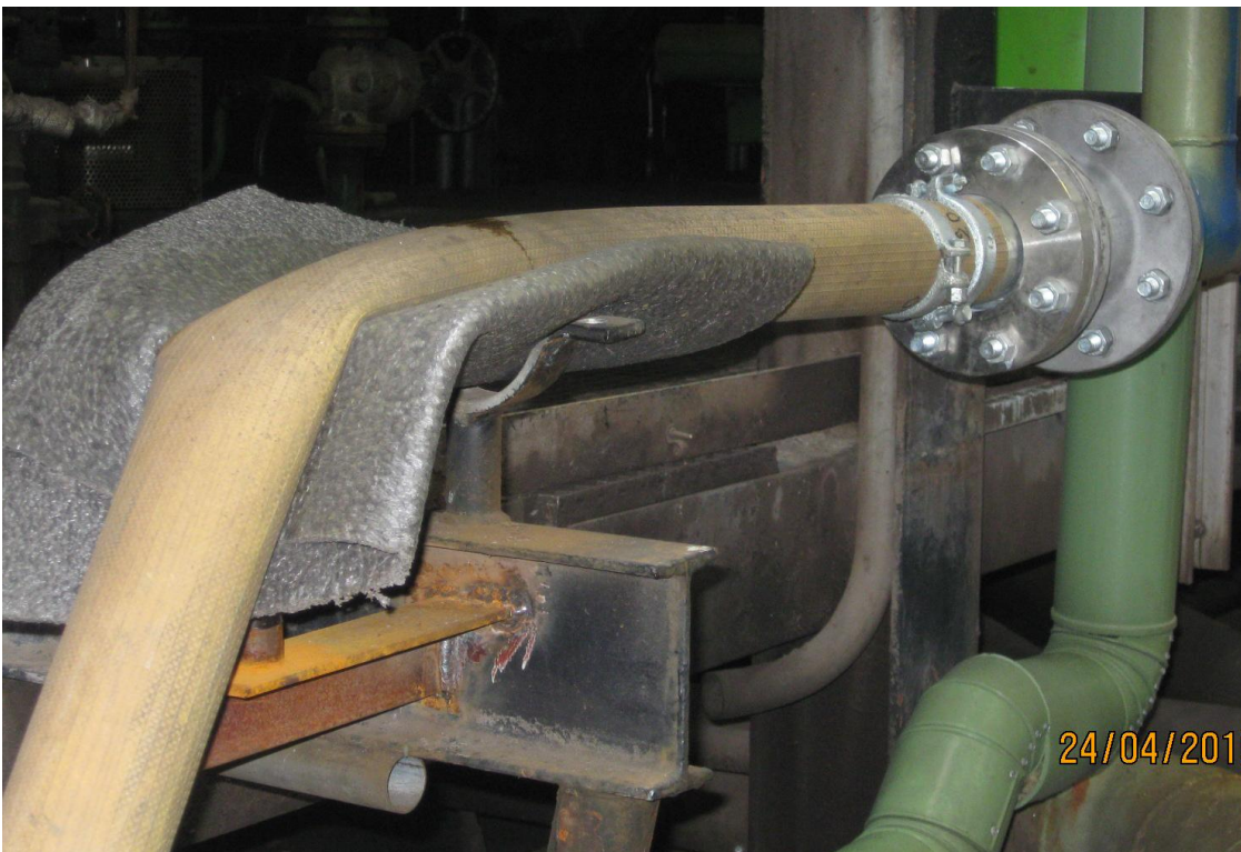
Kuva 8. Käyttöhyödyke 2 kompressorin liitos.
