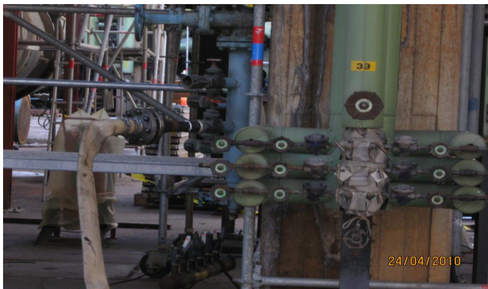
Kuva 28. TL3 paineilmakompressorin liitos.
