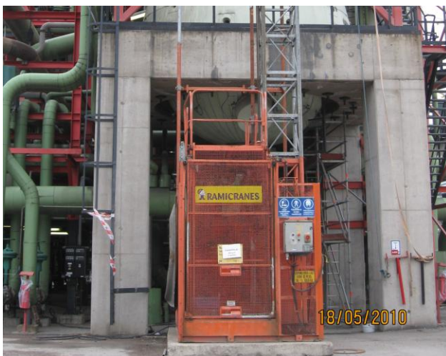
Kuva 18. DC-34001 työmaahissin nostokori.
