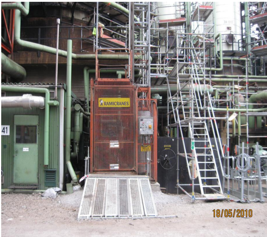
Kuva 30. DA-10101 työmaahissin nostokori.
