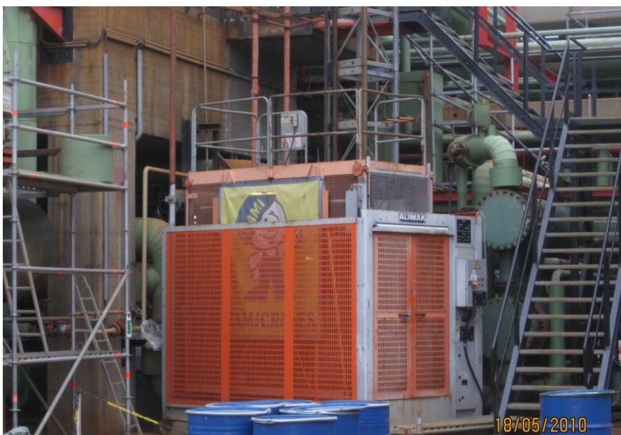
Kuva 23. DA-9802 työmaahissin nostokori.
